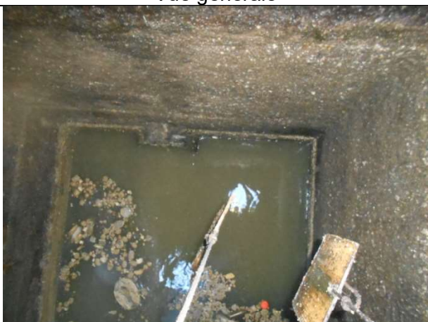
Bâche de pompage
