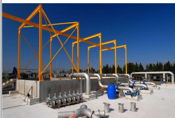
Vue portique membranes
