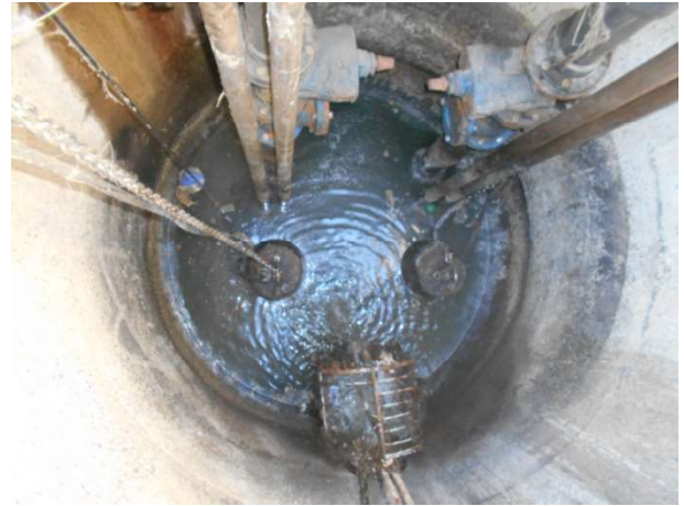
Bâche et Vannes
