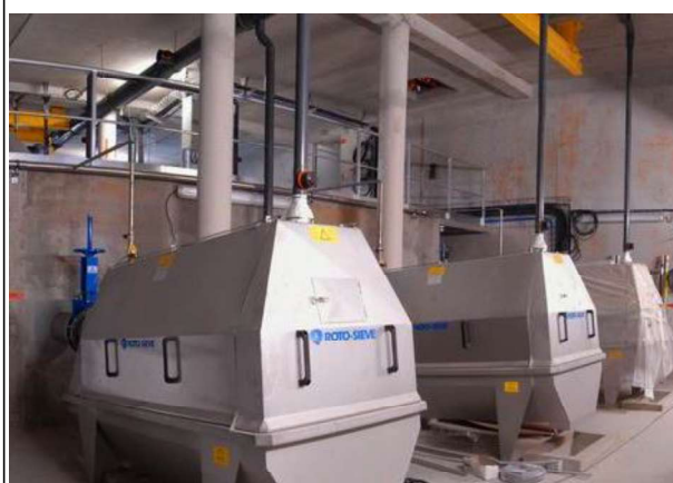
Vue tambours filtrants
