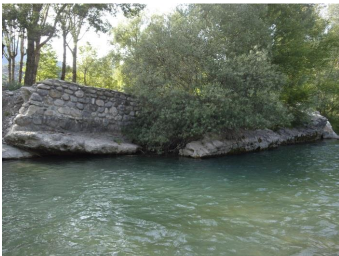
Figure 20. Protection de berge effondrée par affouillement au droit du camping de la Salaou (en rive droite au lieu-dit la Colle)
