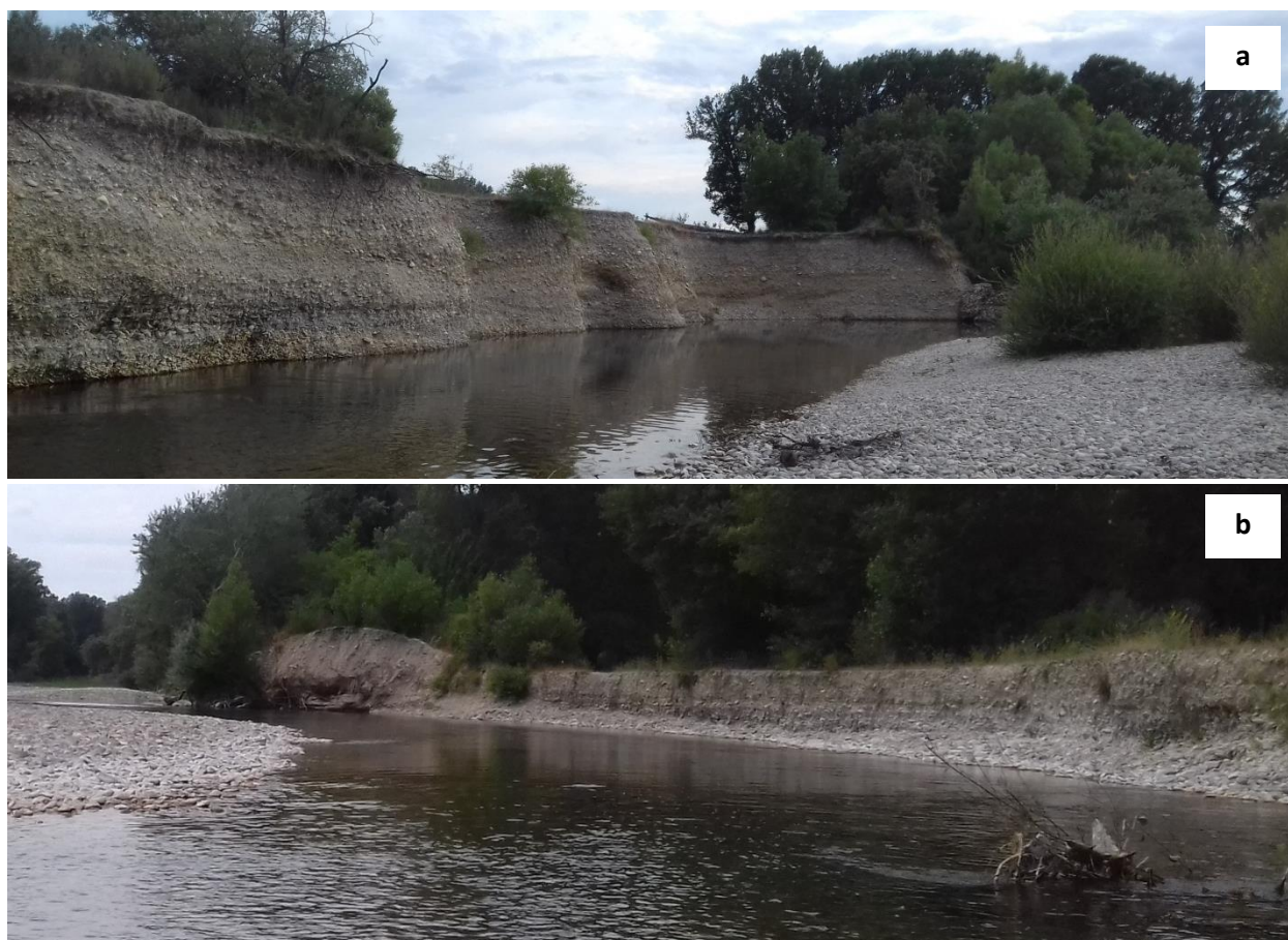
Figure 22. Principales érosions de berge : a) en face de la déchetterie de Gréoux ; b) rive droite qui accueillait la digue fusible en aval de Vinon
