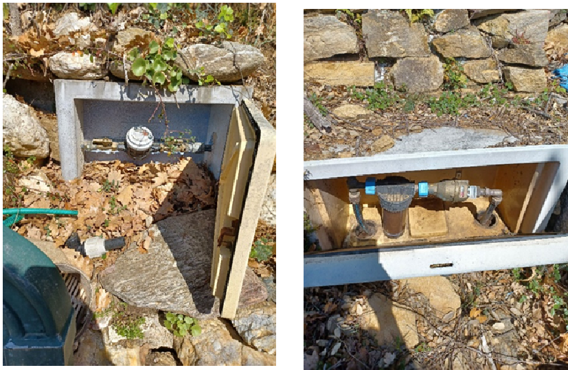
Figure 6 - Exemple de compteur, présence d'un filtre
