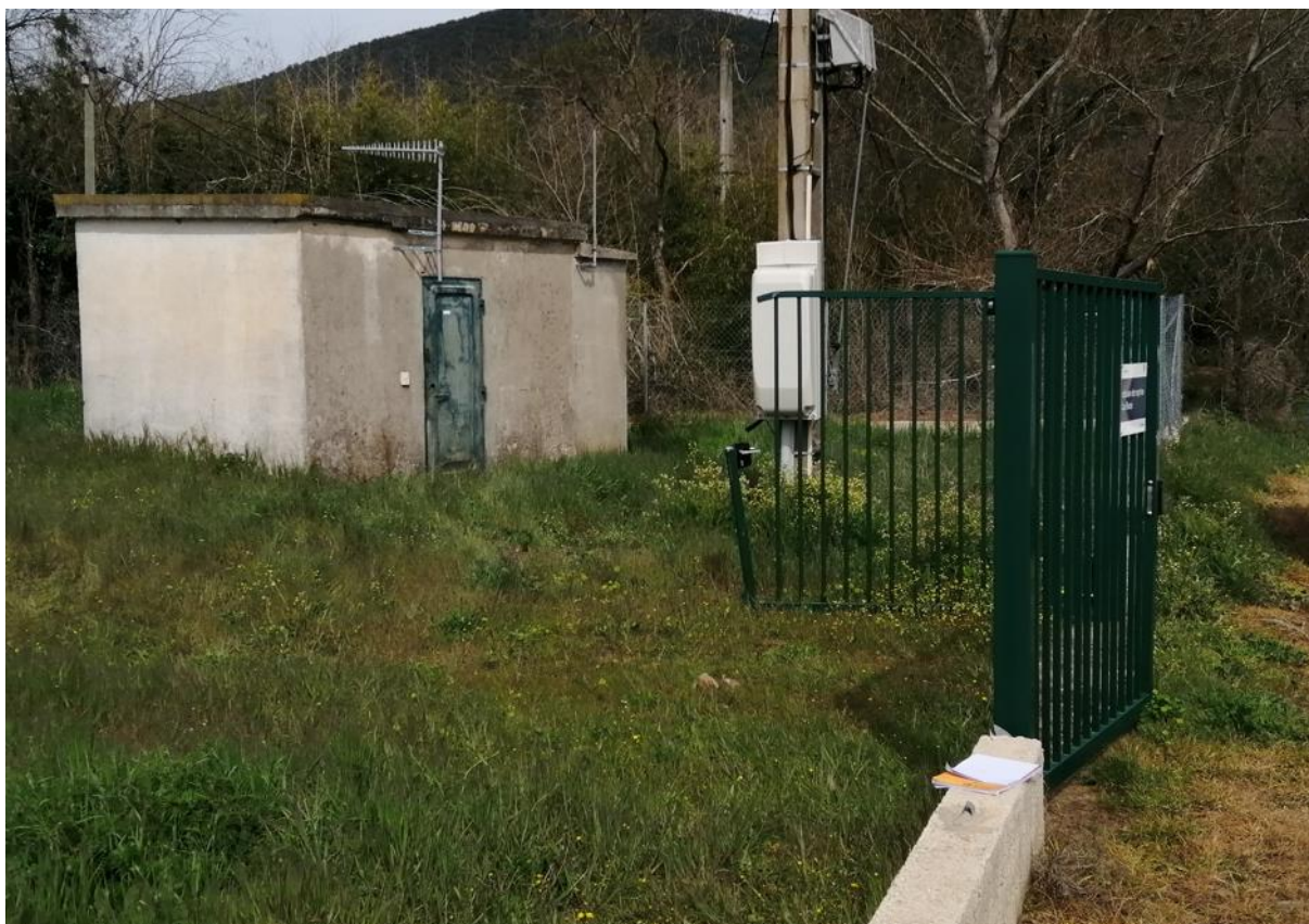
Figure 25 : Absence de clôture et portail abimé
