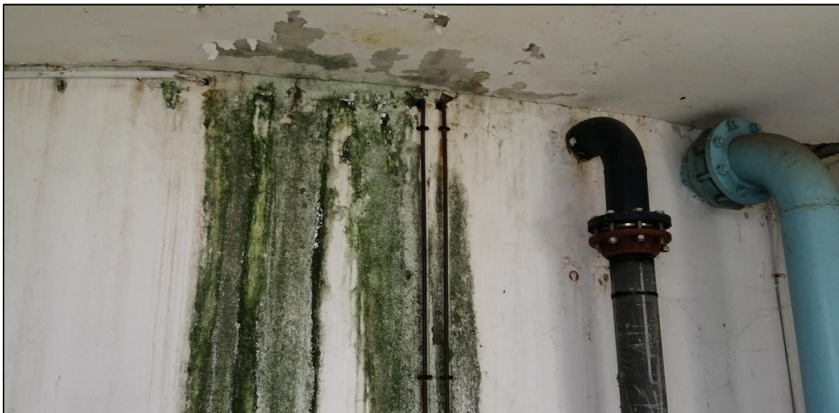
Figure 24 : Traces d'infiltrations dans la chambre de vannes
