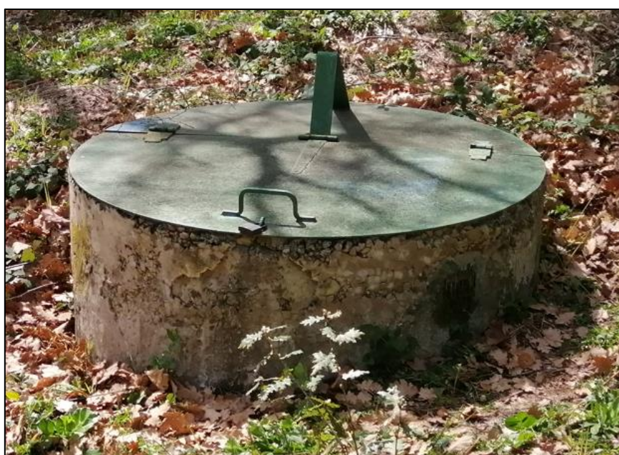
Figure 11 : Défauts de capot et de génie civil du puits des Maurès
