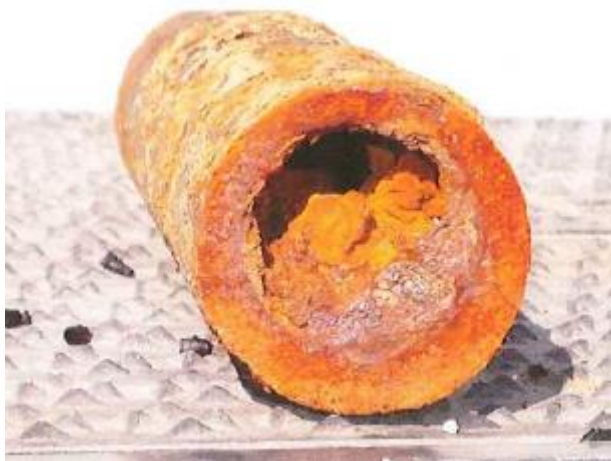
Figure 29 : Etat de la conduite située route de Gonfaron (RAD 2020)
