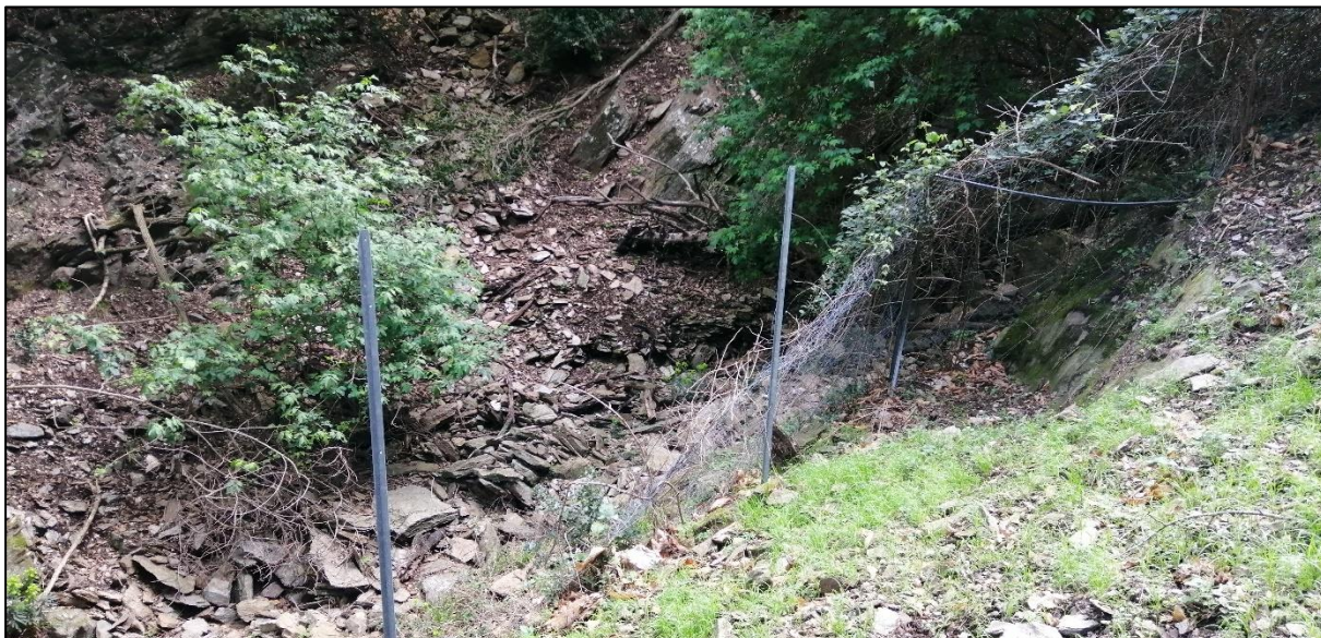
Figure 13 : Etat de la clôture
