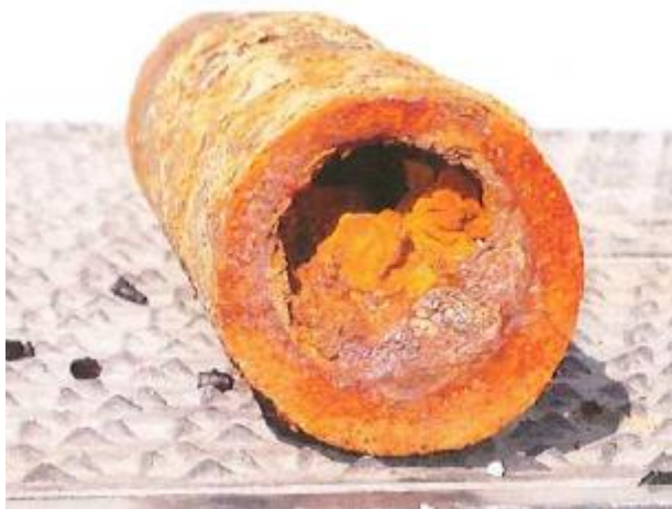
Figure 16 : Etat de la conduite située route de Gonfaron (RAD 2020)
