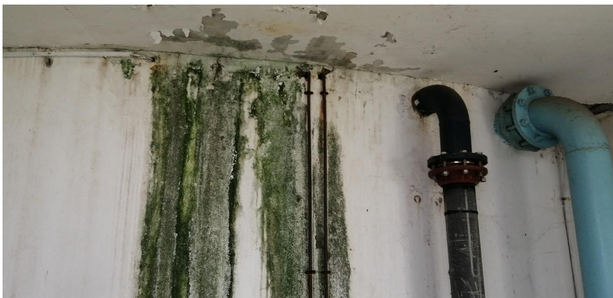
Figure 41 : Traces d'humidité sur le réservoir
