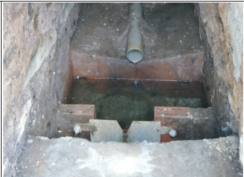
Bac de décantation
