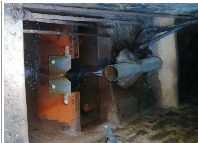
Bac de décantation
