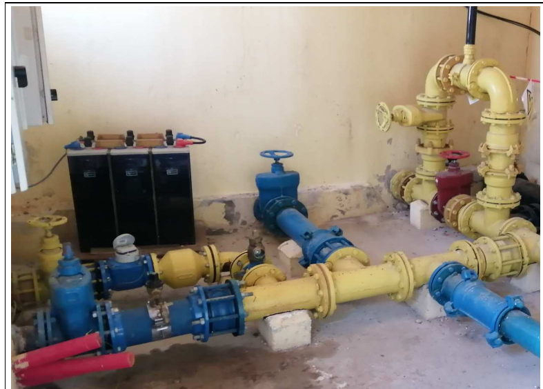
Chambre de vannes
