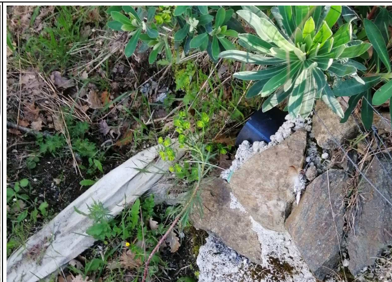
Exutoire trop plein
