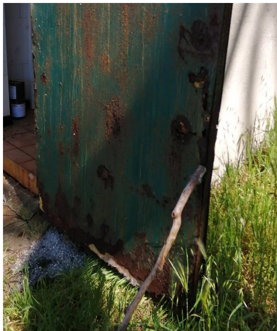
Figure 36 : Porte du local chlore du réservoir Camping
