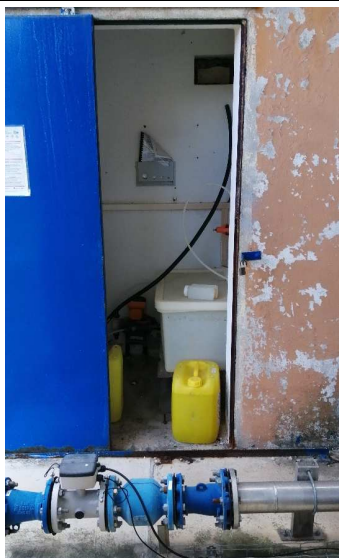
Local chlore - Débitmètre distribution
