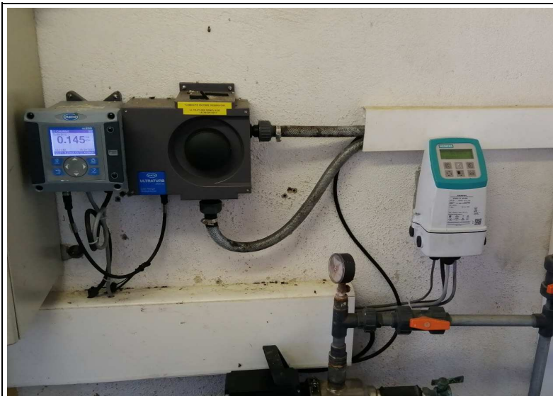
Turbidimètre + afficheur déporté débitmètre - Chambre de vannes (300 m³)
