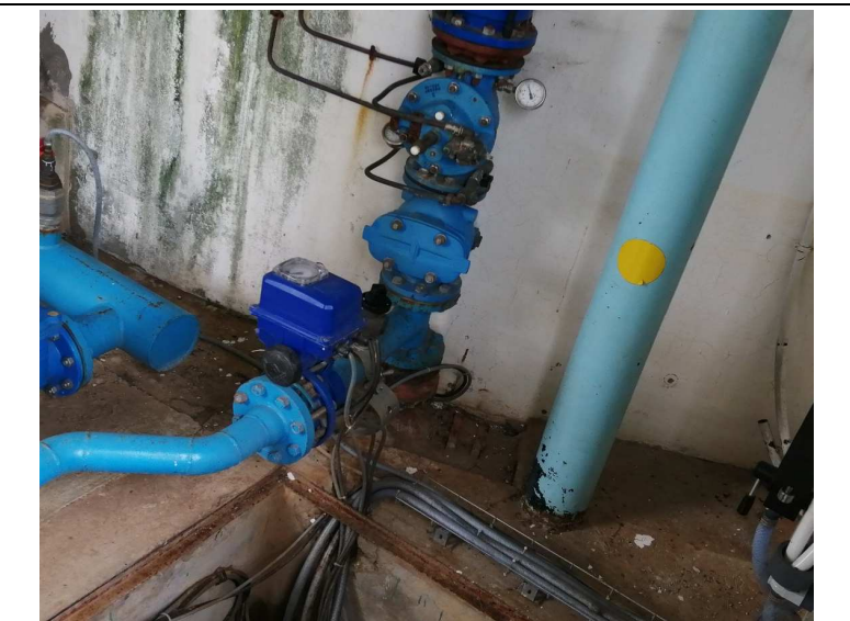
Chambre de vannes - alimentation
