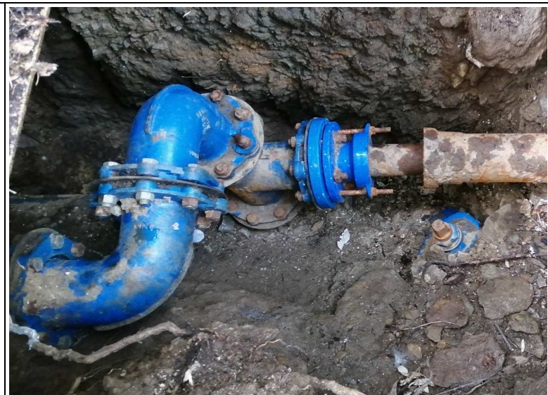
Regard de comptage - départ et trop plein
