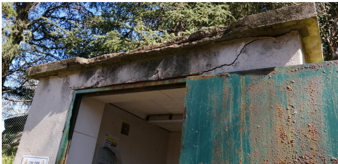
Figure 37 : Armature apparente du local chloration
