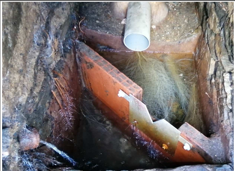
Bac de décantation - arrivée Gréou
