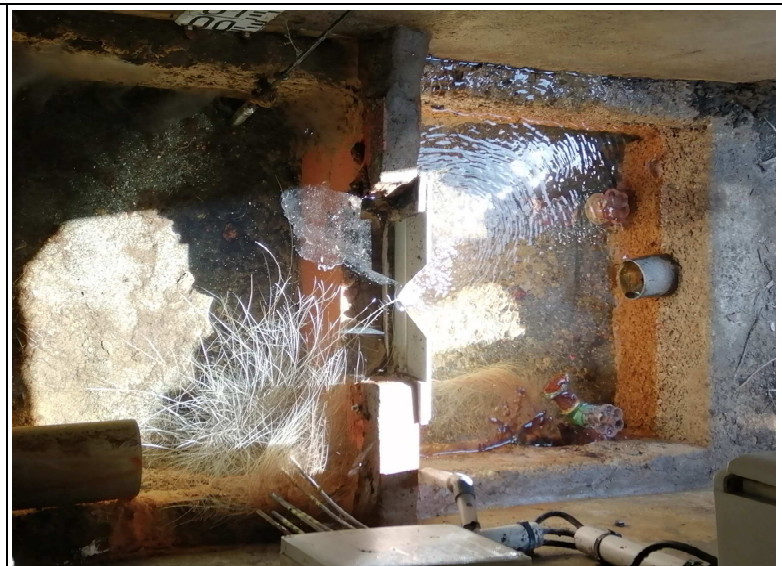
Bac de décantation
