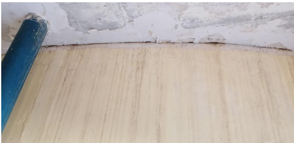
Figure 38 : Traces d'infiltration et armature apparente sur le réservoir des Claux
