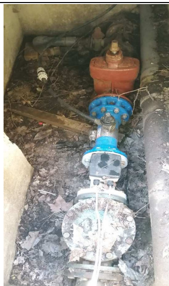
Regard extérieur avec débitmètre
