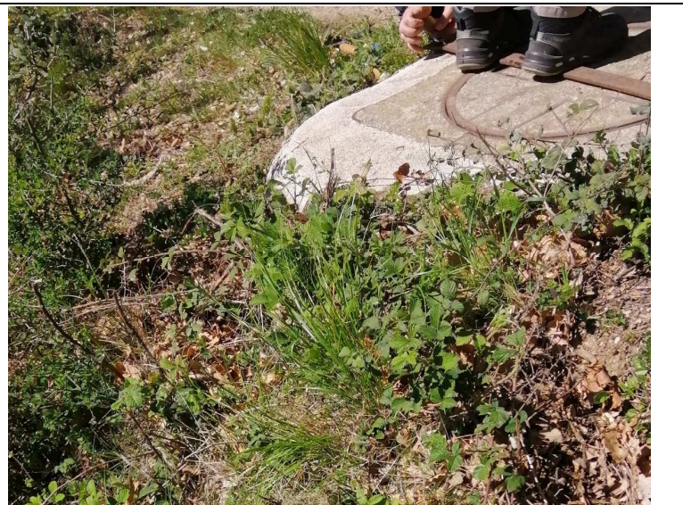
Exutoire trop plein
