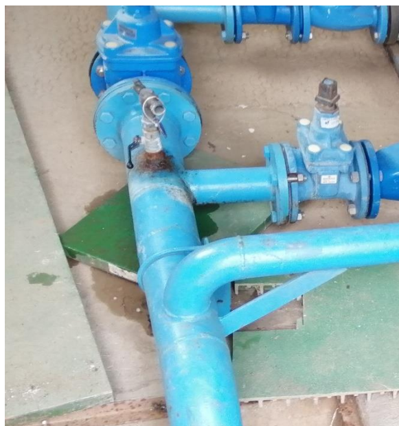
Figure 42 : Traces de fuite au niveau de la canalisation de distribution
