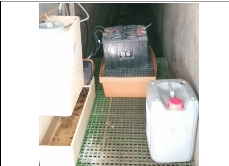
Système de chloration
