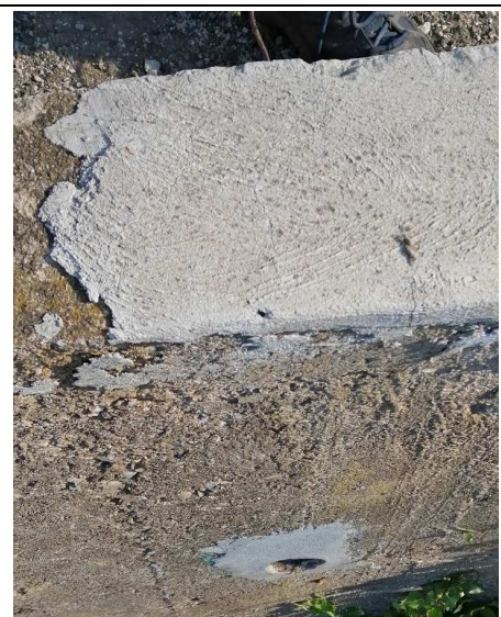
Exutoire trop plein
