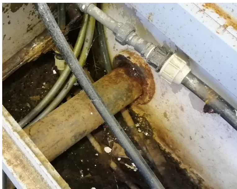
Figure 35 : Fuite sur canalisation dans la chambre de vannes du réservoir 300 m 3
