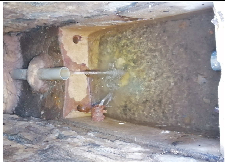
Bac de décantation
