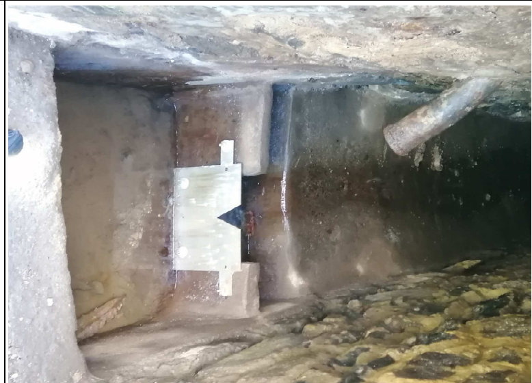
Bac de décantation
