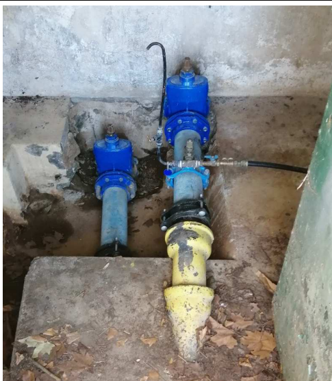
Alimentation et vidange - Chambre de vannes (600 m 3 )
