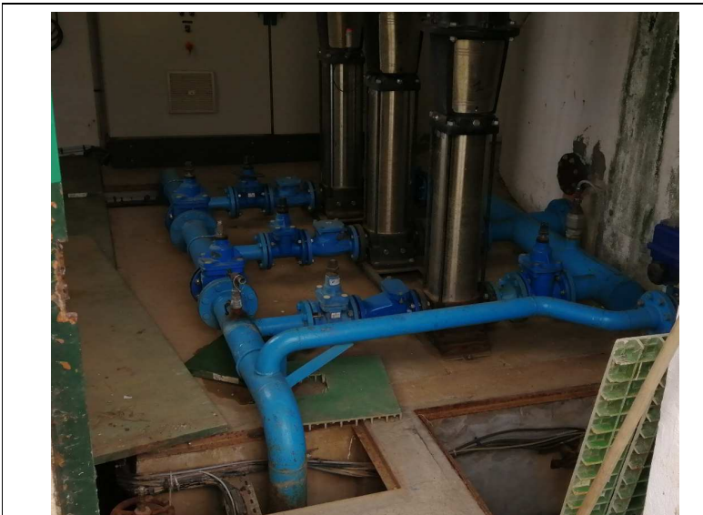
Chambre de vannes
