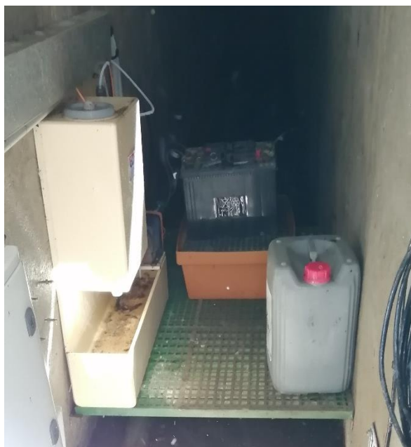
Figure 44 : Système de chloration sur Rouve Gavot
