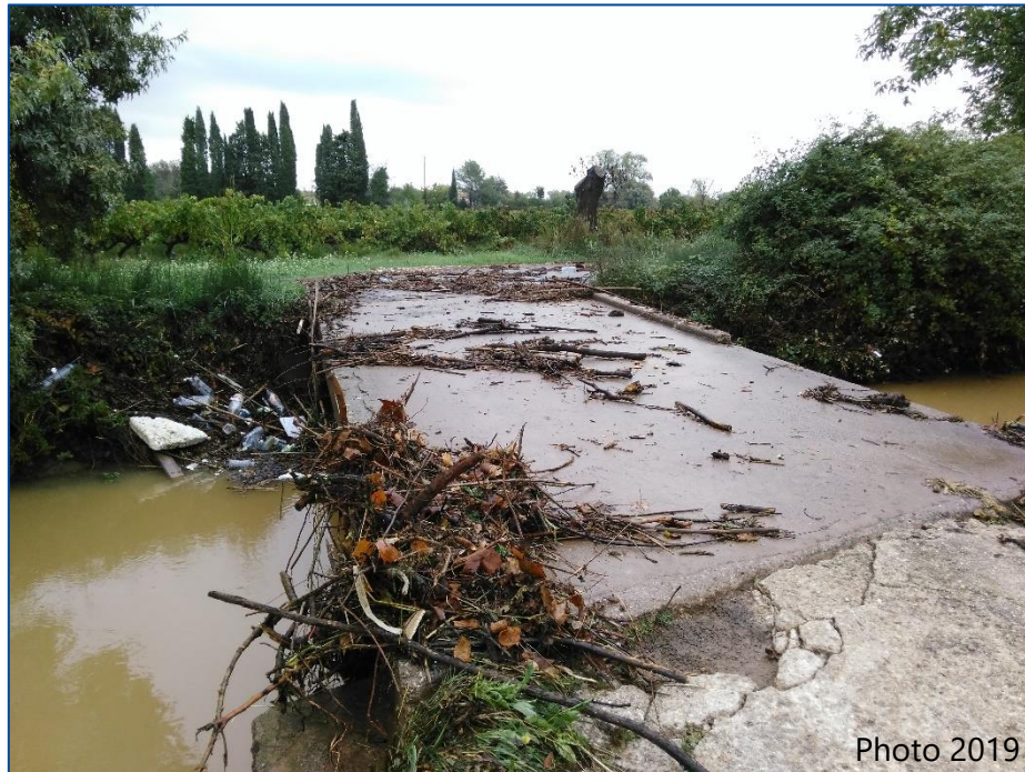
Figure 14 Pont route des Mayons après la crue Novembre 2019
