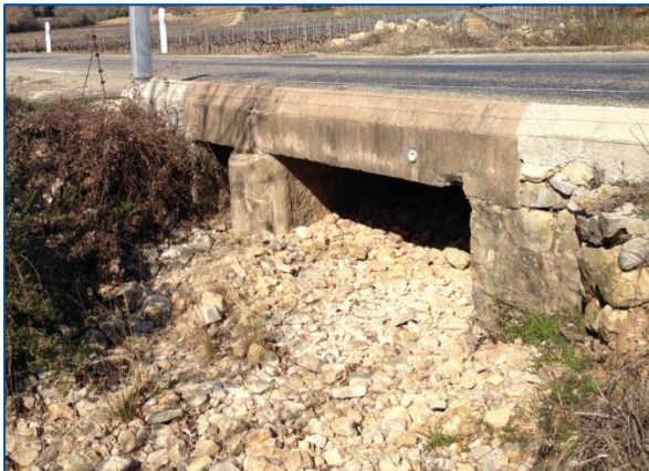
Figure 3 Buse pour passage sous RD33 - Soliès amont
