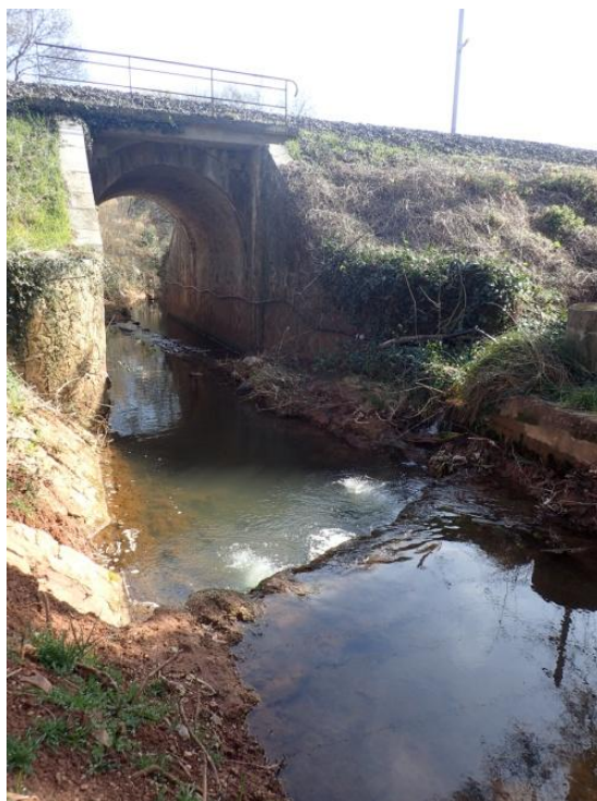
Figure 53. Ouvrage de franchissement de la voie ferrée à l'amont du tronçon Riautort 2. Source : Morph'eau Conseils, 2019.
