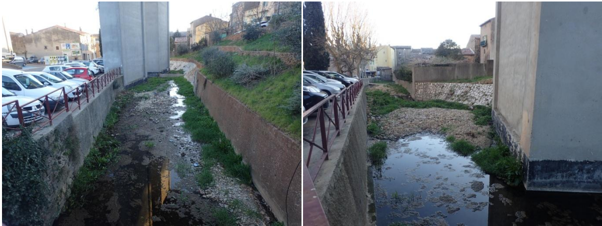
Figure 23. Piliers de l'autoroute A 48 dans le lit du Soliès et accumulation sédimentaire en aval. Source : Morph'eau Conseils, 2019.
