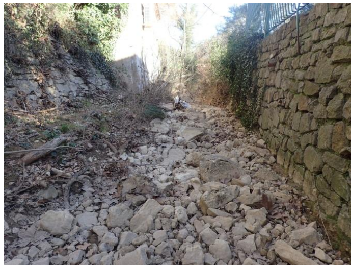
Figure 43. Morphologie du lit sur le tronçon Coudounier 5 (à gauche). Ouvrage affouillé (PK 0,9) (à droite) Source : Morph'eau Conseils, 2019.
