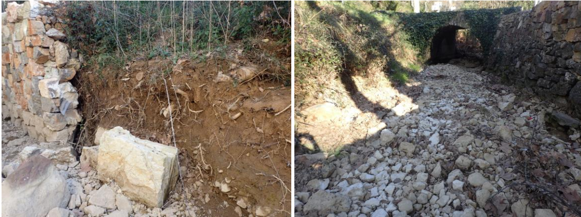
Figure 44. Ouvrage affouillé (PK 0,9) (à gauche) et accumulation sédimentaire en amont du pont COU_PT_10 (à droite). Source : Morph'eau Conseils, 2019.
