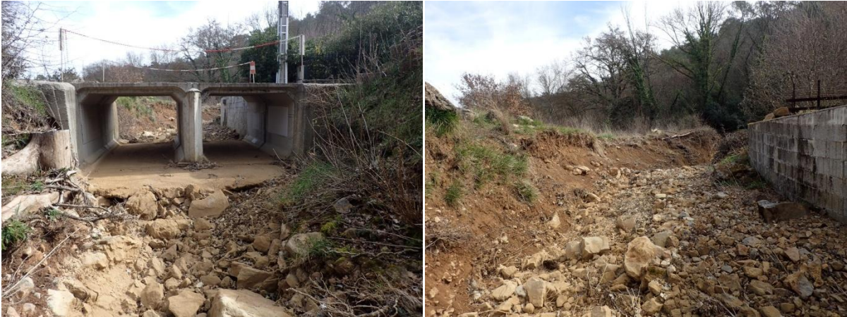
Figure 40. A gauche : vue amont du pont affouillé (COU_PT_4). A droite : érosion de berge et accumulation sédimentaire en aval du pont.
