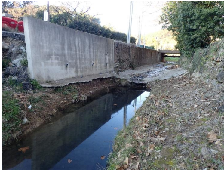
Figure 21. Affouillement du radier bétonné du pont SOL_PT_9. Source : Morph'eau Conseils, 2019.
