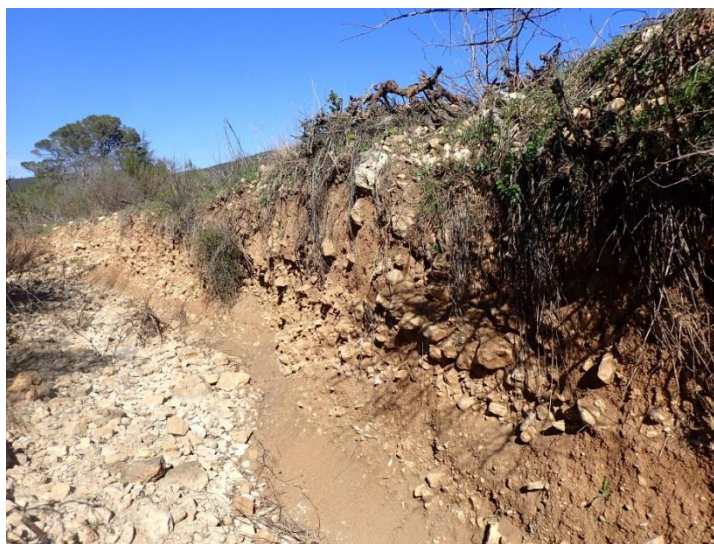
Figure 16. Erosion de berge sur le tronçon Soliès 1. Source : Morph'eau Conseils, 2019.
