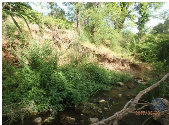
Importante érosion au droit du contournement du seuil (OH R-6)
