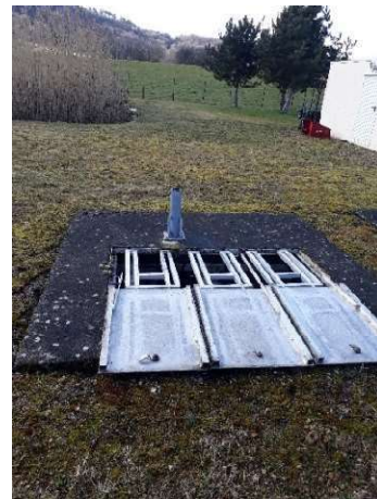
Ouvrage de pompage 2
