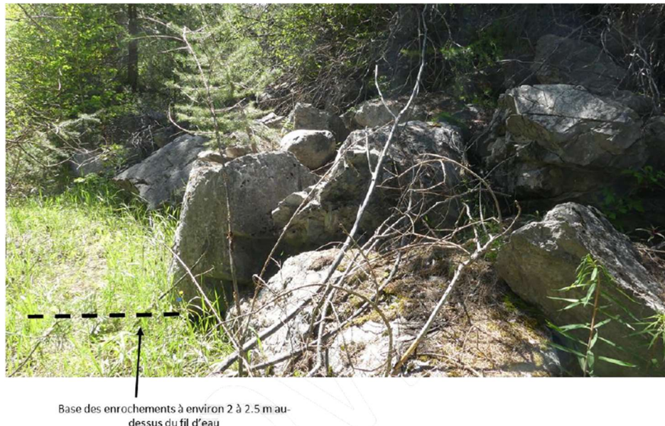
Fig. 21. Zone des Planissaux - protection existante de la RD 947 en aval de la zone
