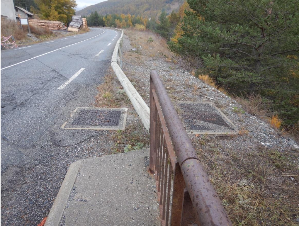
Figure 104 : Bas-côté étroit en amont du franchissement du torrent de Platenq par la RD 947 (vue vers l'amont)
