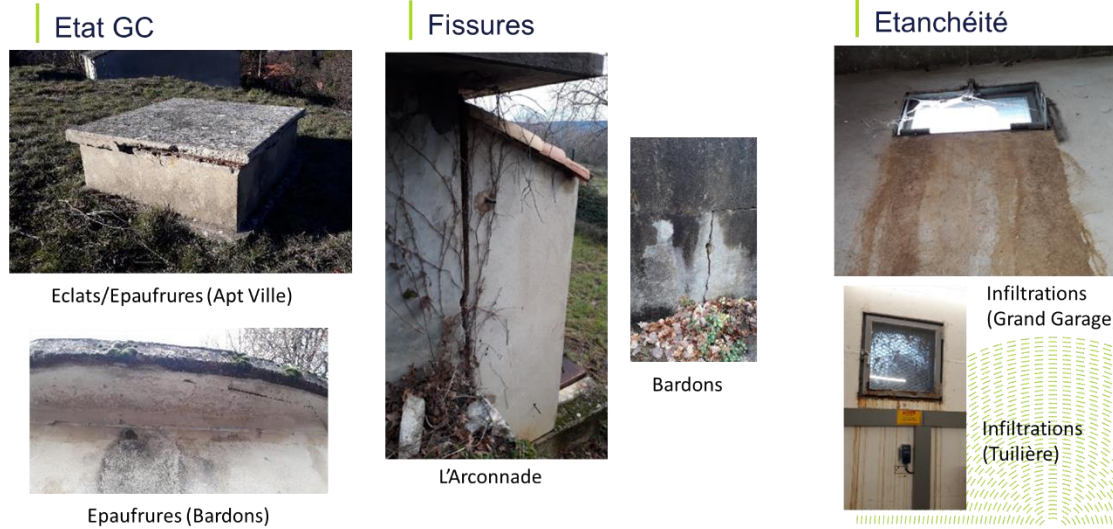
Figure 79 Type de désordres observés sur les ouvrages de la CCPAL [Extrait présentation de l'Atelier GC]
