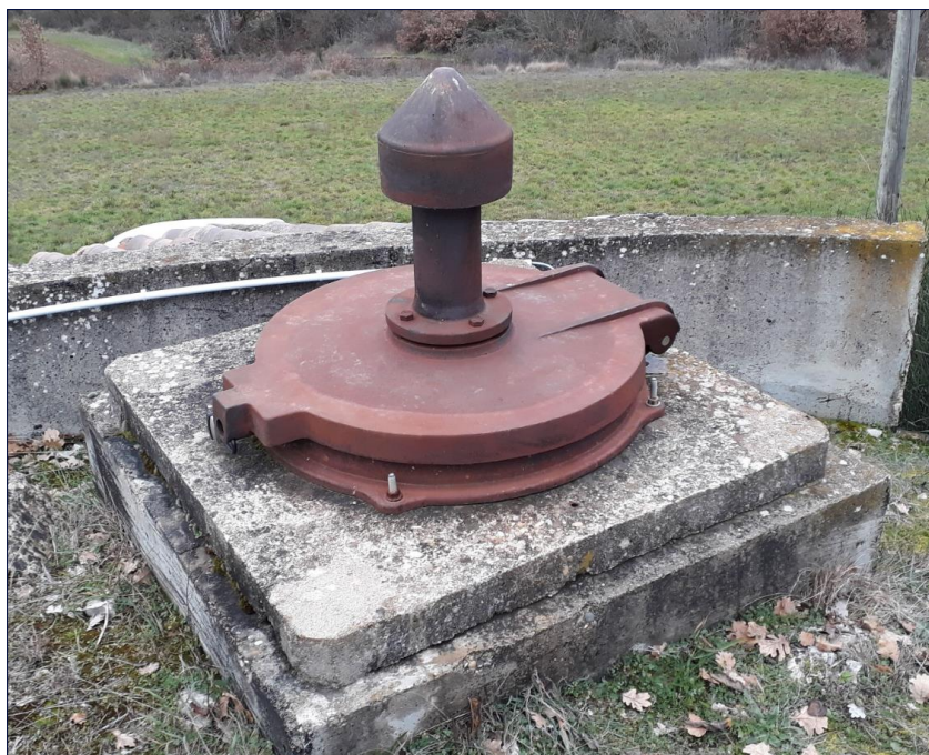
Figure 99 Exemple de capot ancien observé lors de l'audit des réservoirs
