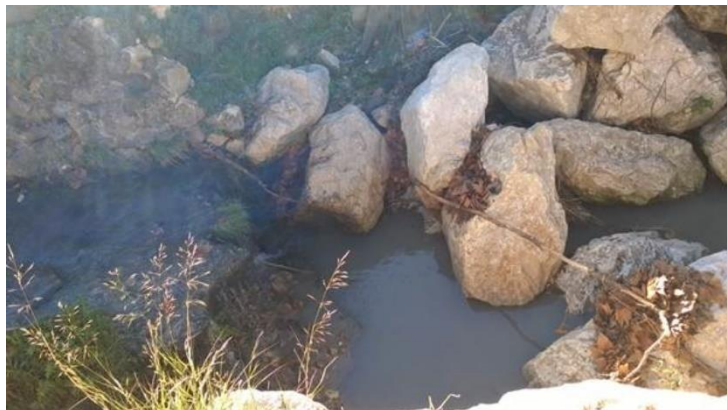
Figure 12 : Enrochements en mauvais état en pied de berge
