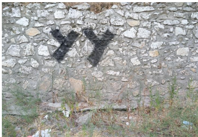
Désordre n° 14 : Erosion de pied
