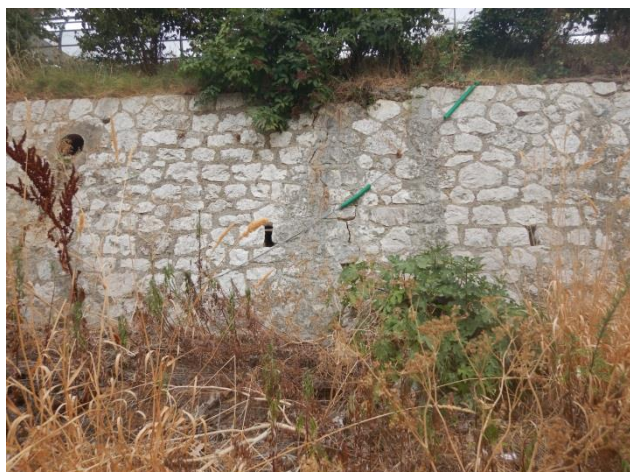
Désordre n° 11 : Fissure dans la maçonnerie
