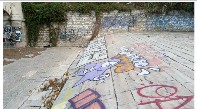
Photo 12 : Seuil en amont du pont Michelet, déstabilisation des dalles en aval du seuil. A reprendre, déjà présent en 2015
