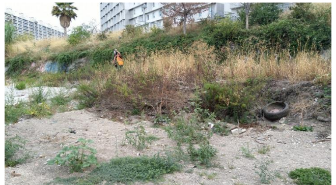
Photo 10 : Dépôts sédimentaires à l'amont du Pont Michelet, végétation importante sur la berge en rive droite.
