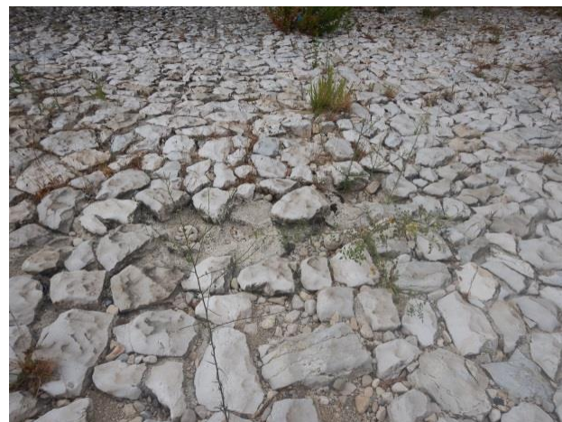
Désordre n° 20 : Béton de jointoiement du radier érodé
