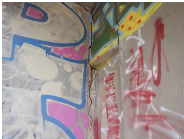
Désordre n° 6 : Désordre sous l'encorbellement à l'extrémité aval vraisemblablement dû à l'absence de joint de dilatation
