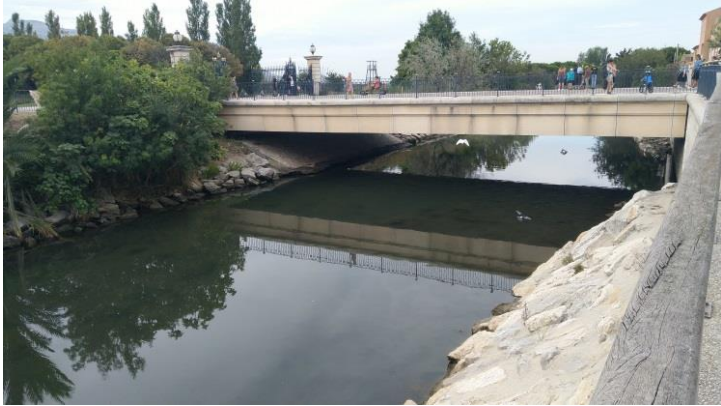
Photo 67 : Amont du pont Borély et affouillement sous la culée en rive gauche est toujours présent depuis 2015
