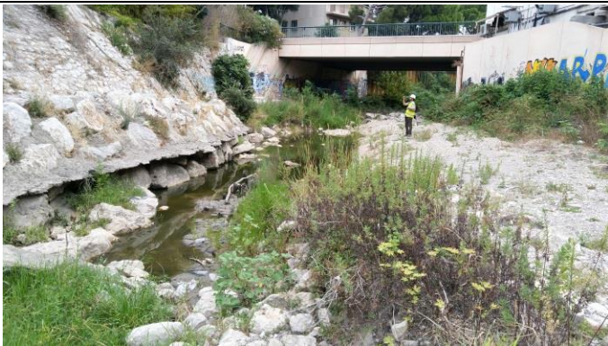
Photo 33 : Erosion de la berge en enrochements liés en rive droite en amont du pont de Mazargues (vue vers l'amont), déjà présente en 2015
