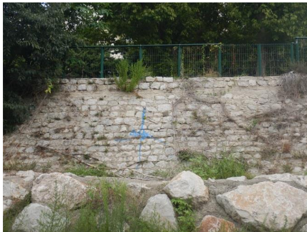
Désordre n° 42 : Mortier de jointolement détérioré
