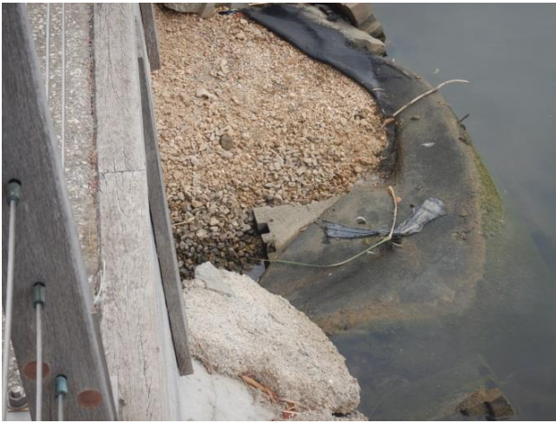
Désordre n° 57 : Effondrement avec affouillement d'environ 1 m sous le cheminement piéton
