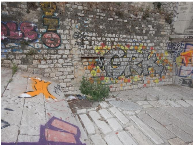
Désordre n° 21 : Mortier de jointoiement érodé en aval du seuil
