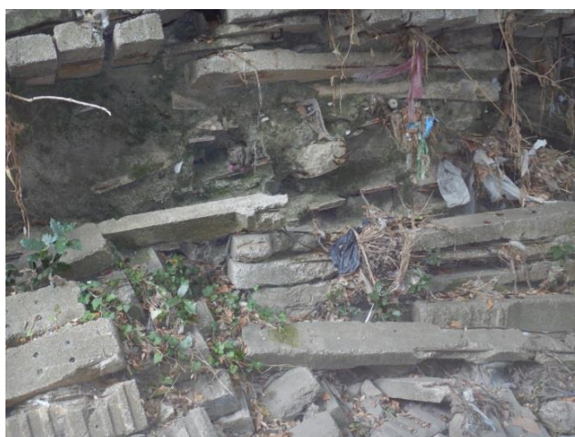
Désordre n° 48 : Effondrement de la protection de berge
