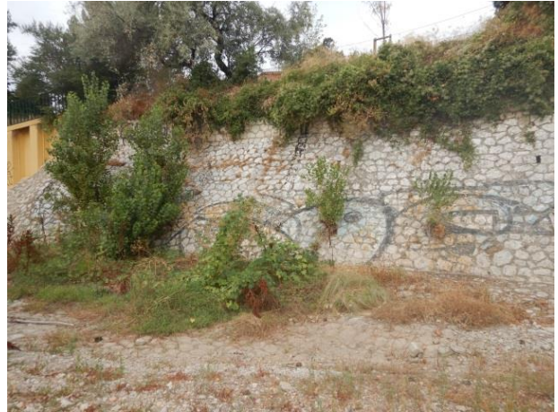
Désordre n° 26 : Végétation dans barbacane
