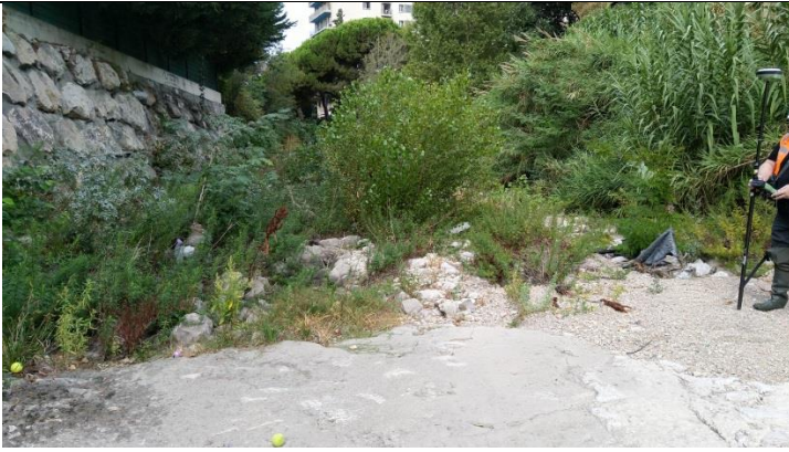
Photo 27 : Atterrissement et végétation importante dans le lit (à la hauteur de l'ASPTT Marseille Tennis)
