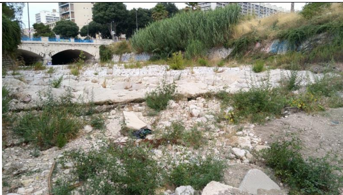
Photo 11 : Dégradation du lit et végétation à l'amont du pont Michelet (vue vers l'aval). Placer une ligne d'enrochement en amont pour éviter une érosion de l'aménagement
