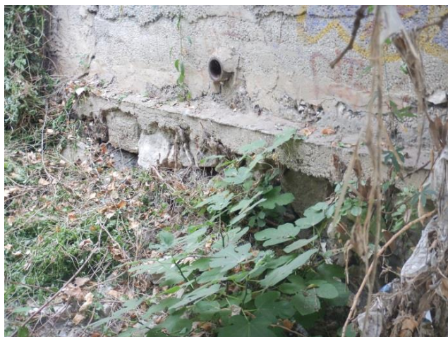
Désordre n° 45 : Affouillement du pied de mur
