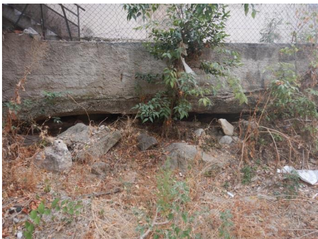
Désordre n° 17 : Afouillement sous fondation / instabilité
