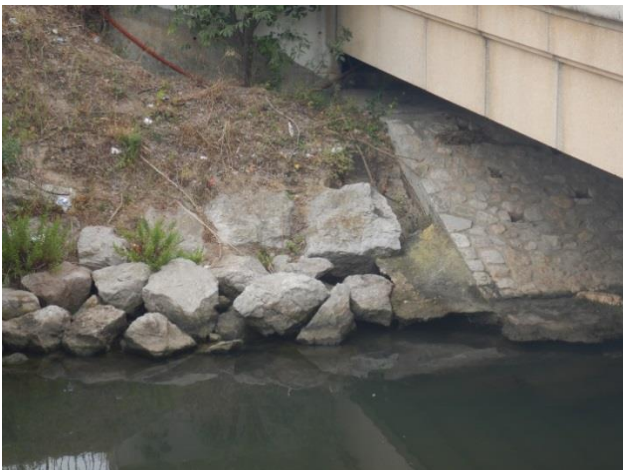
Désordre n° 59 : Affouillement sous la culée
