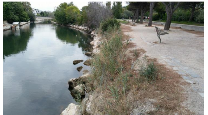
Photo 72 : Rive gauche en amont de la base nautique, déjà dégradé en 2015
