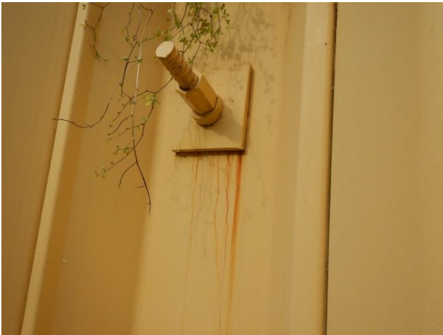
Désordre n° 27 : Traces de corrosion au niveau des têtes d'ancrages des tirants
