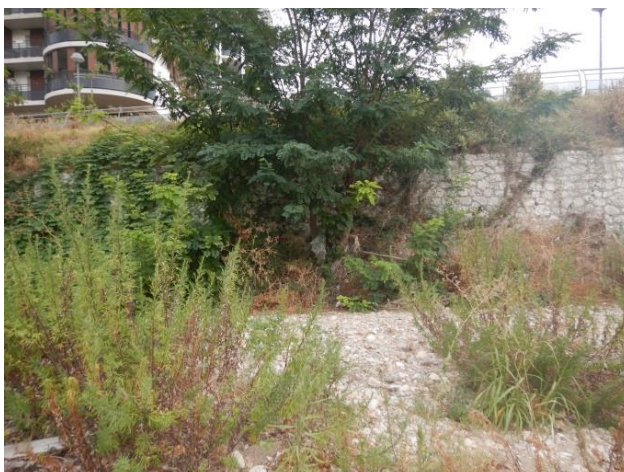
Désordre n° 12 : Végétation dans la maçonnerie
