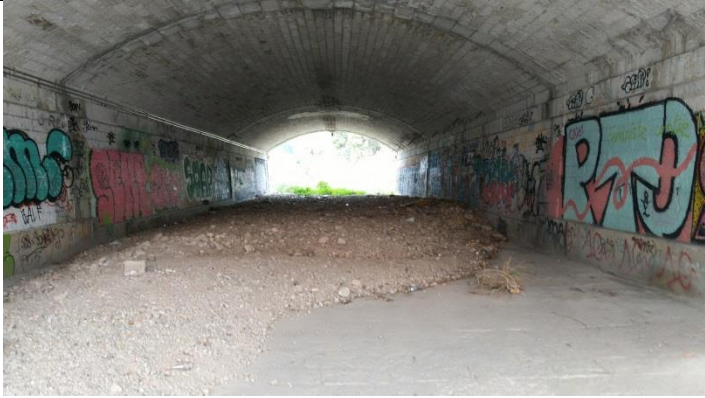
Photo 13 : Atterrissement sous le pont Michelet. A surveiller pour éviter le colmatage progressif de l'ouvrage
