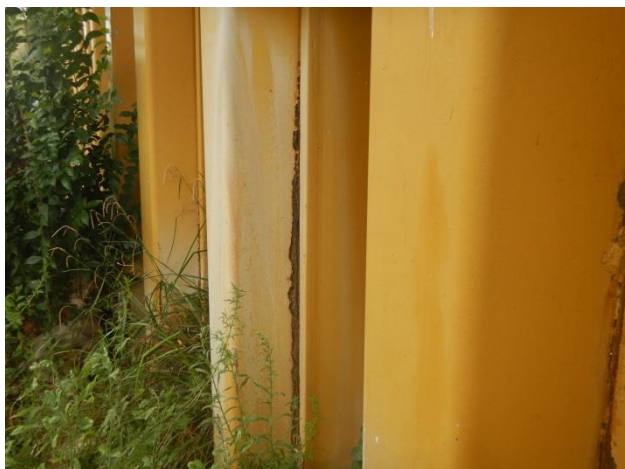
Désordre n° 35 : Traces de corrosion en pied et présence de fruit d'environ + ou - 1 %
