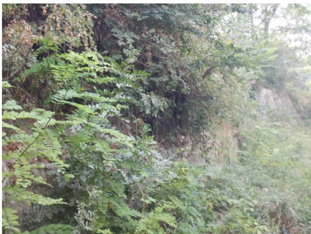
Désordre n° 43 : Végétation importante dans maçonnerie
