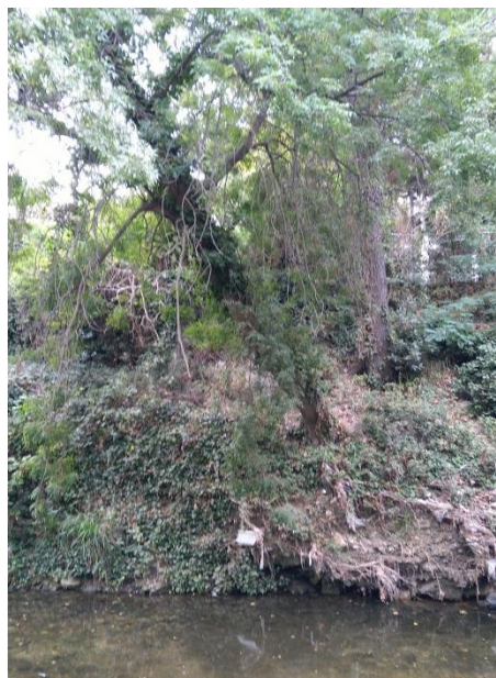
Désordre n° 50 : Erosion de berge
