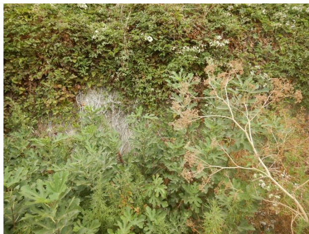
Désordre n° 18 : Forte présence de végétation
