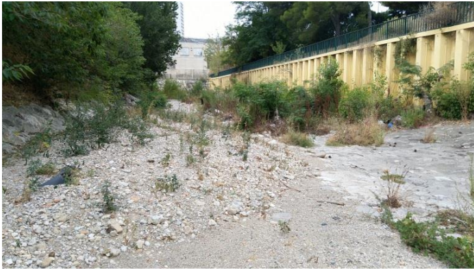
Photo 19 : Atterrissement en rive gauche au niveau du stade Alex Caujolle
