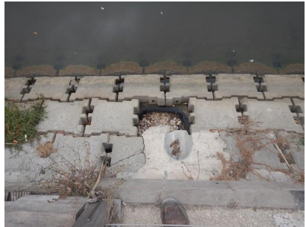
Désordre n° 58 : Afouillement sous rejet
