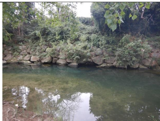
Photo 58 : Berge en enrochements libres en rive gauche au niveau du parc Henri Fabre. Les enrochements doivent être repris
