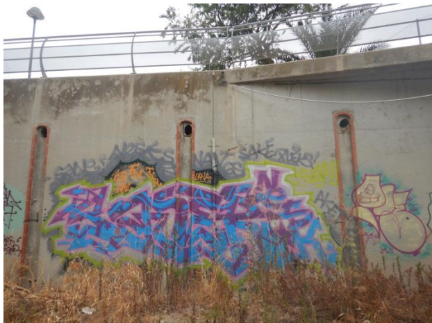
Désordre n° 9 : Armatures apparentes au niveau des décaissées de rejet d'eaux pluviales
