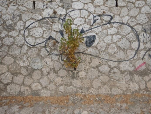
Désordre n° 25 : Végétation dans barbacane
