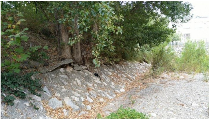
Photo 21 : Berge en enrochement dégradée en rive gauche au niveau du stade Alex Caujolle, déjà identifié en 2015
