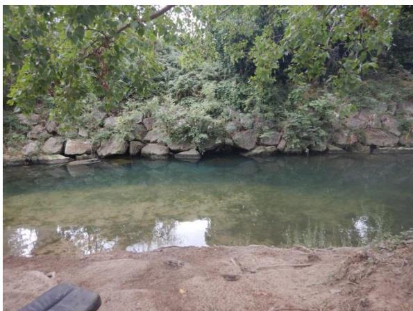
Désordre n° 53 : Affouillement sous berge
