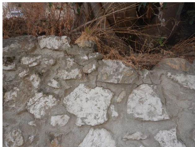
Désordre n° 16 : Fissure due à la présence de végétation
