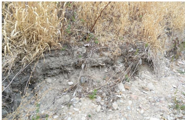
Désordre n° 10 : Afouillement localisé
