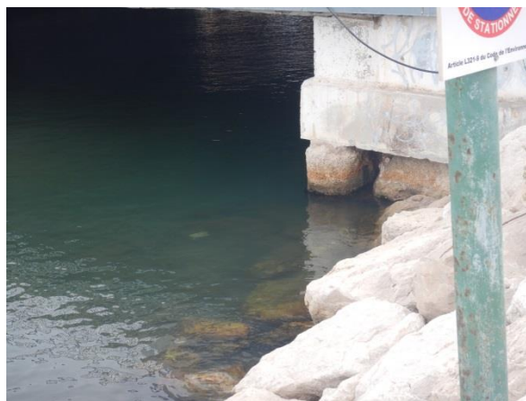
Désordre n° 64 : Affouillement sous la culée
