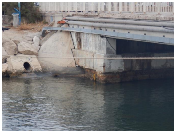
Désordre n° 63 : Corrosion des armatures et affouillement sous la culée
