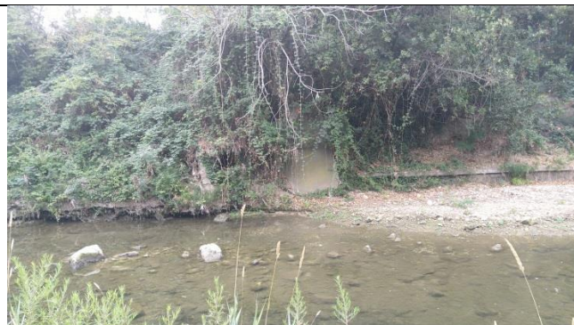
Photo 60 : Les fondations du mur sont hors d'eau. L'ouvrage peut s'effondrer en cas de sollicitation hydraulique.
