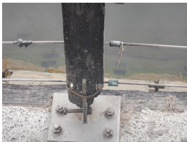
Désordre n° 56 : Poteau de garde-corps partiellement brûlé (résistance)
