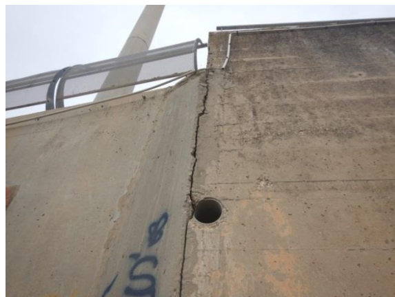
Désordre n° 2 : Fissure à la liaison avec l'ouvrage en génie civil du seuil
