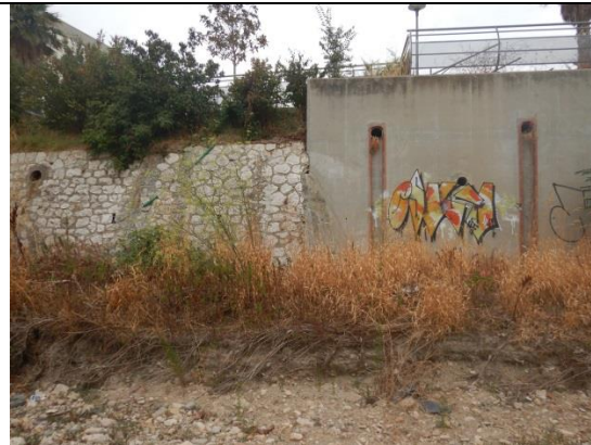
Photo 4 : Affouillement localisé du lit en rive gauche au niveau du parking du Stade Delort
