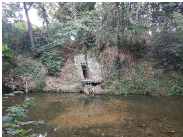
Désordre n° 51 : Afouillement sous berge et basculement de l'ouvrage de rejet
