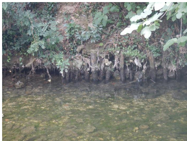
Désordre n° 52 : Pourrissement des protections de berges
