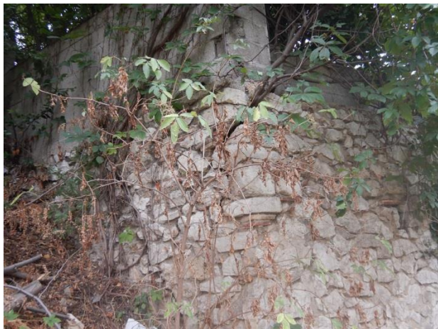
Désordre n° 37 : Présence de fissures sur le retour et présence de végétation
