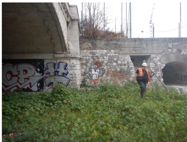
Désordre n° 24 : Corrosion des armatures de la rehausse en béton armé
