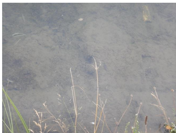
Désordre n° 55 : protection en mauvais état
