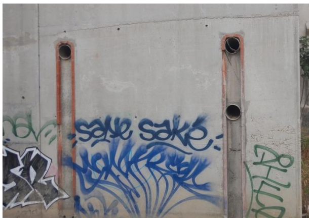
Désordre n° 1 : Armature apparente au niveau d'un décaissé (rejet d'eaux pluviales)
