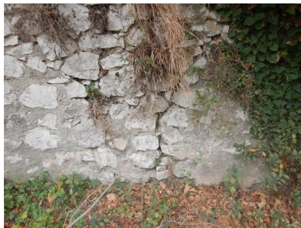
Désordre n° 36 : Mortier de jointolement érodé
