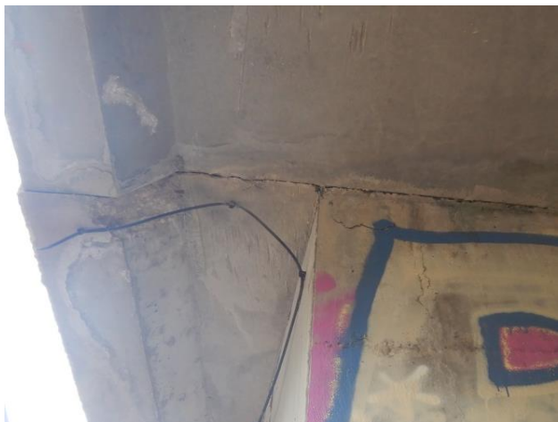
Désordre n° 7 : Eclatement du béton (corrosion de l'armature)
