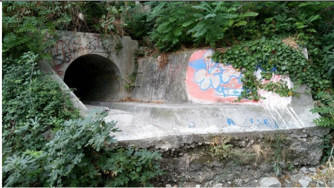
Photo 37 : Ouvrage de rejet en rive gauche du bras secondaire de l'îlot de Mazargues
