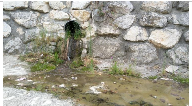
Photo 4 : Rejet non identifié
