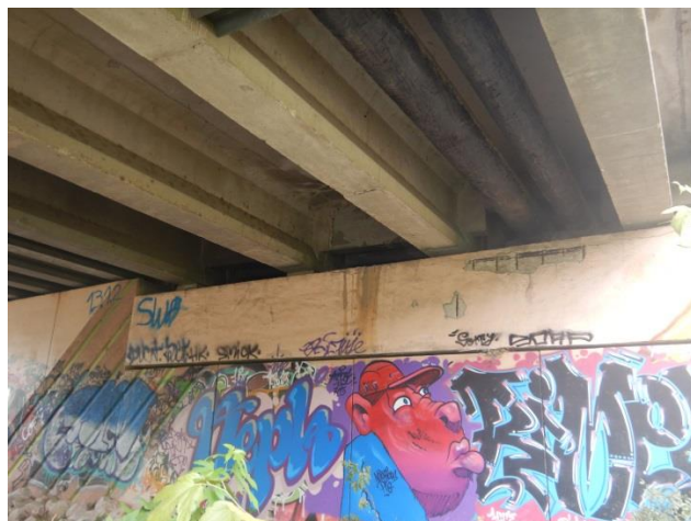
Désordre n° 38 : Corrosion des armatures de la culée
