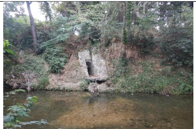
Photo 48 : Ouvrage de rejet instable (déchaussement en cours) en rive gauche, déjà identifié en 2015
