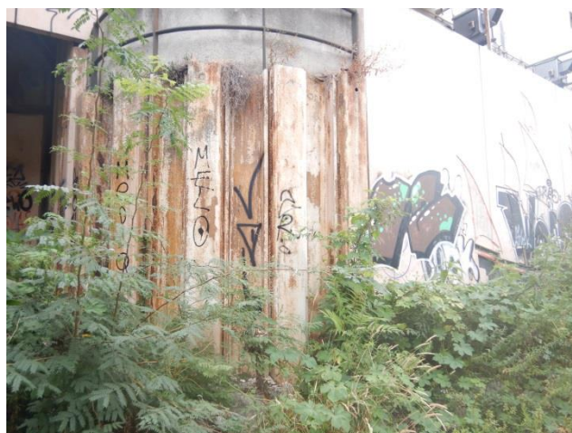
Désordre n° 40 : Corrosion des palplanches
