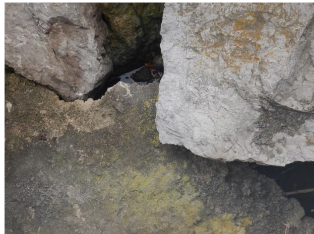
Désordre n° 60 : Erosion entre les blocs d'enrochement et la culée en amont et en aval
