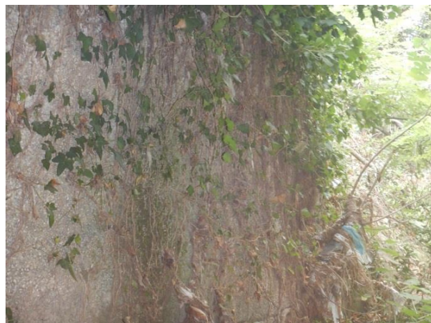
Désordre n° 46 : Déversement du mur
