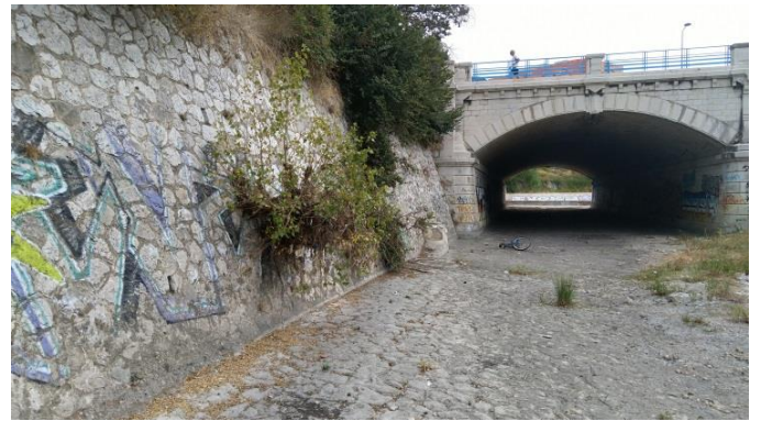
Photo 16 : Pont du Boulevard Michelet, végétation dans le mur en rive droite (vue vers l'amont)
