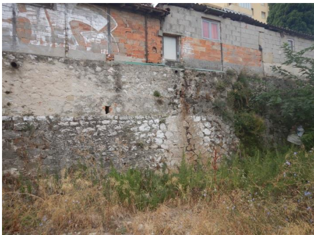
Désordre n° 5 : Végétation dans maçonnerie
