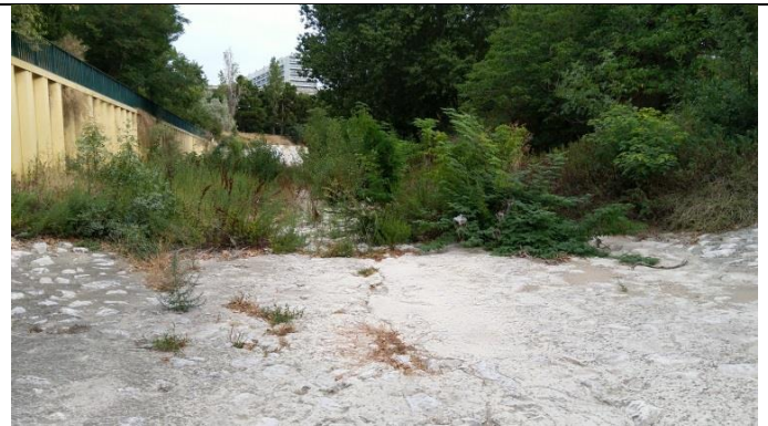
Photo 24 : Lit végétalisé et radier érodé au niveau de l'ASPTT
