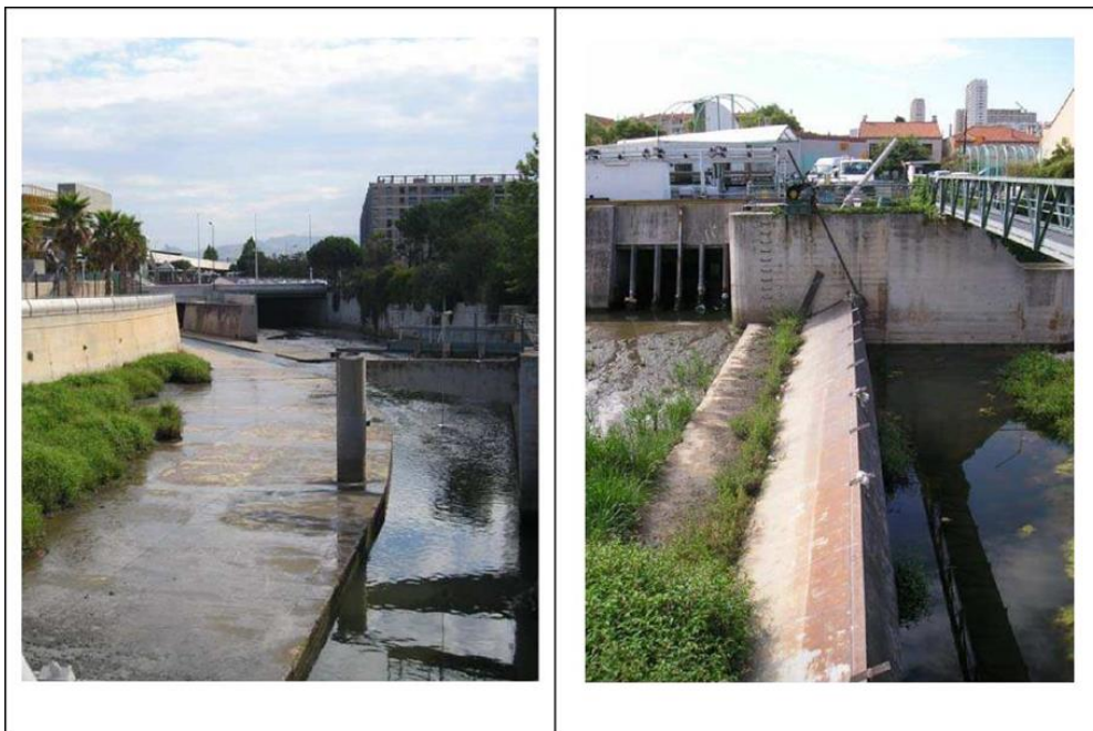
Figure 2 : Confluence de l'Huveaune et du Jarret en amont du barrage et vanne barrage en position intermédiaire basse 3
