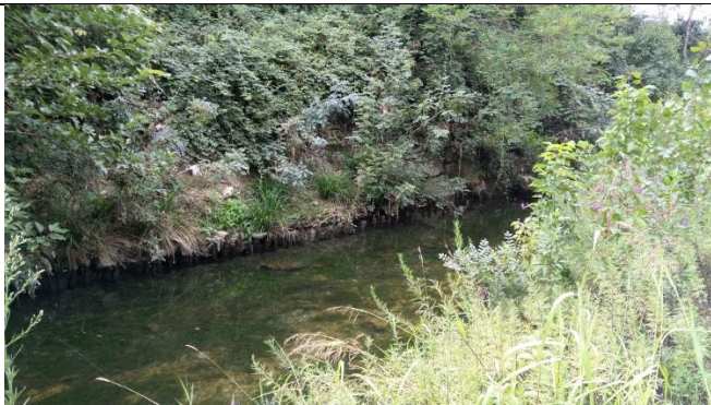
Photo 55 : Affouillement sous berge en rive gauche au niveau de l'école de Danse à préserver pour maintenir des habitats potentiels
