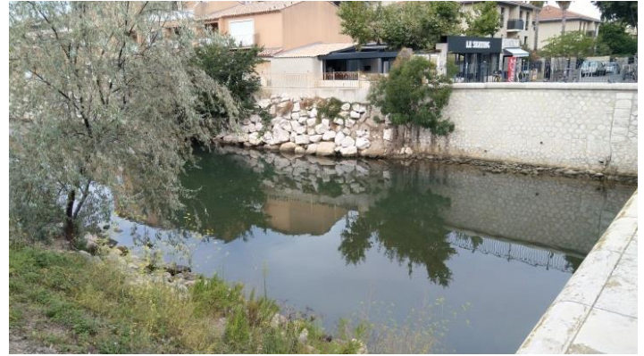
Photo 68 : Fondations du mur hors d'eau. Dégradation depuis 2015
