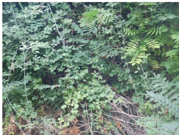
Désordre n° 44 : Végétation importante
