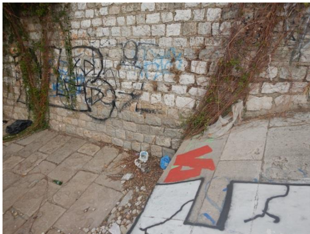
Désordre n° 22 : Mortier de jointoiement érodé en aval du seuil
