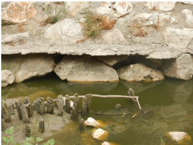
Désordre n° 41 : Afouillement sous berge / instabilité
