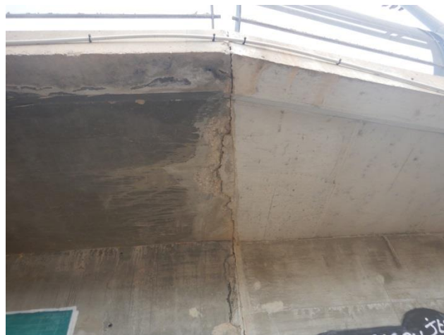
Désordre n° 4 : Désordre sous l'encorbellement à l'extrémité
