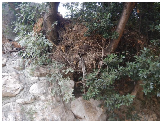
Désordre n° 34 : Présence d'arbres (dont certains morts) au niveau du raccordement au talus pouvant fragiliser l'enrochement
