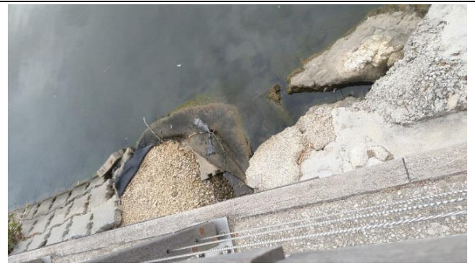
Photo 66 : La protection du sentier pédestre s'est dégradée depuis 2015. En affouillement est présent sous le platelage
