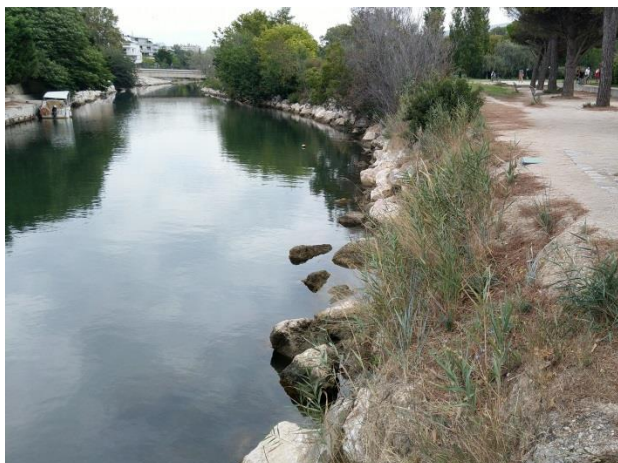
Désordre n° 61 : Enrochements dérochés
