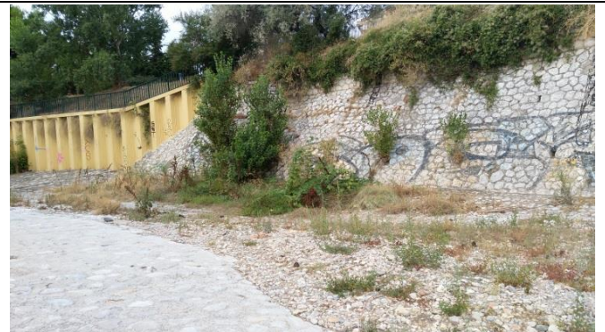
Photo 18 : Végétation dans les barbacanes en rive droite au niveau du stade Alex Caujolle
