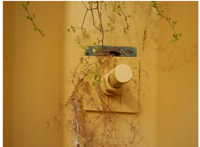
Désordre n° 28 : Tirants désactivés
