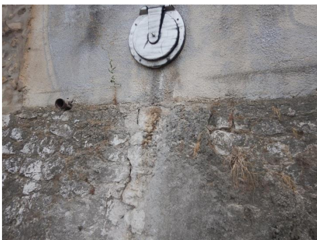
Désordre n° 3 : Erosion du mortier de jointoiment au droit de rejets d'eau
