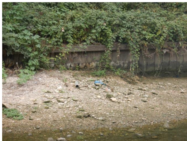
Désordre n° 54 : Atterrissement et de la protection de berge en bois
