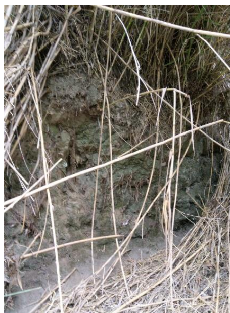
Désordre n° 47 : Erosion entrainant l'instabilité
