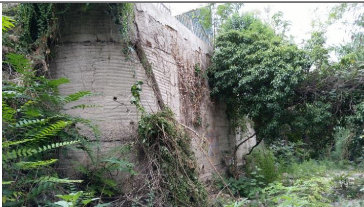
Photo 39 : Dégradation du mur en rive gauche du bras secondaire de l'îlot de Mazargues, déjà identifié en 2015
