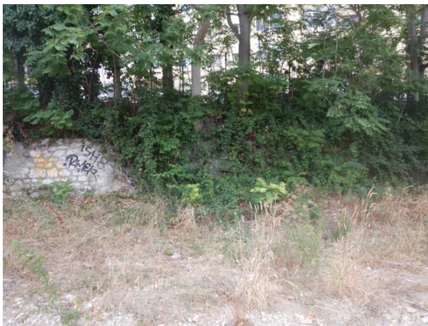
Désordre n° 8 : Présence importante de végétation (Ronces Ailante)
