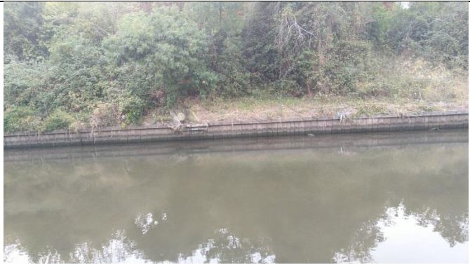
Photo 65 : Rive gauche depuis le sentier pédestre de l'Huveaune. La qualité de la protection de berge en bois se dégrade
