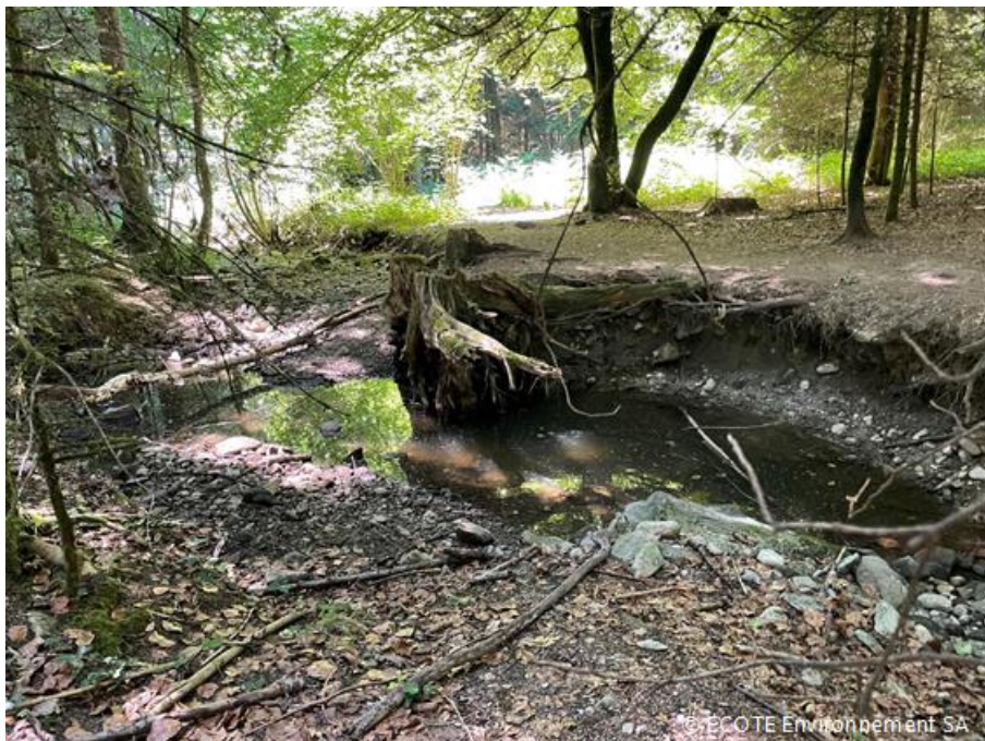
Figure 20 : Erosion de berge sur la Maravant en aval de Larringes
