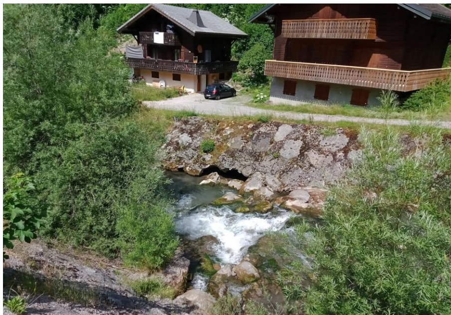
Figure 3 : Affouillement d'ouvrage en enrochements liés, signe d'instabilité du lit sur la partie aval du Malève
