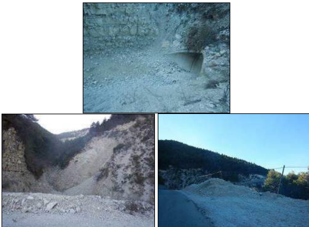
Figure 15 : Ravin d'Inarde à la traversée avec la D908
