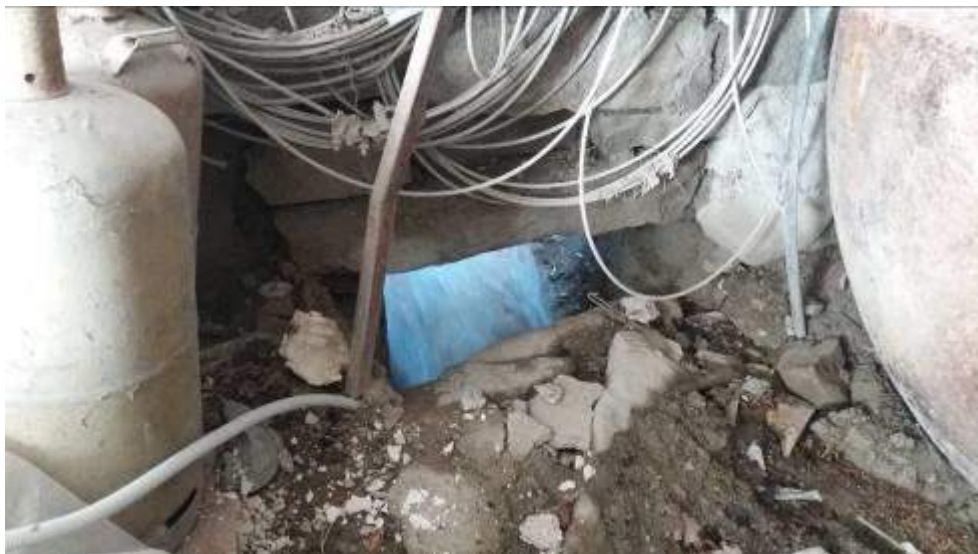
Figure 33 : Partie souterraine du canal de dérivation. On note la forte vitesse des écoulements.
