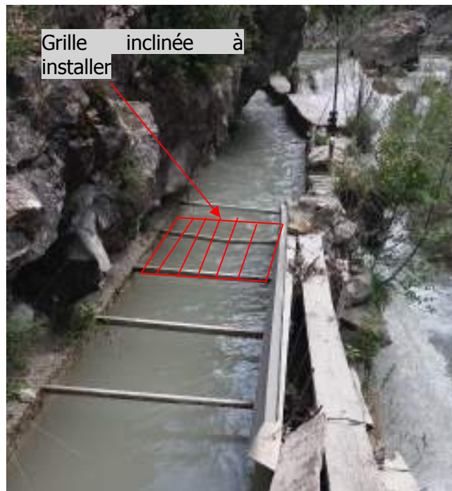
Figure 11 : Zone d'installation de la grille.
