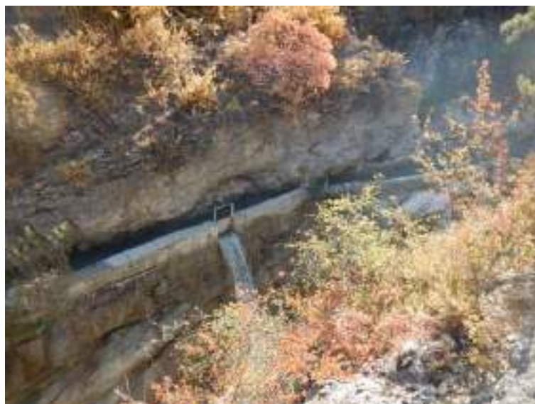
Figure 6 : Vue de la prise d'eau depuis le haut de berge en rive gauche.
