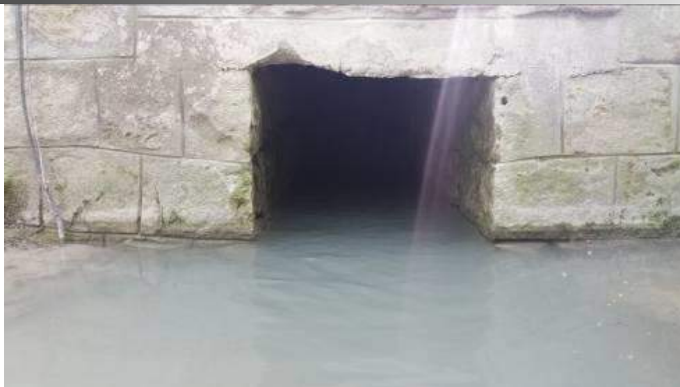
Figure 34 : Sortie du canal de dérivation, hors période de fonctionnement de la centrale.
