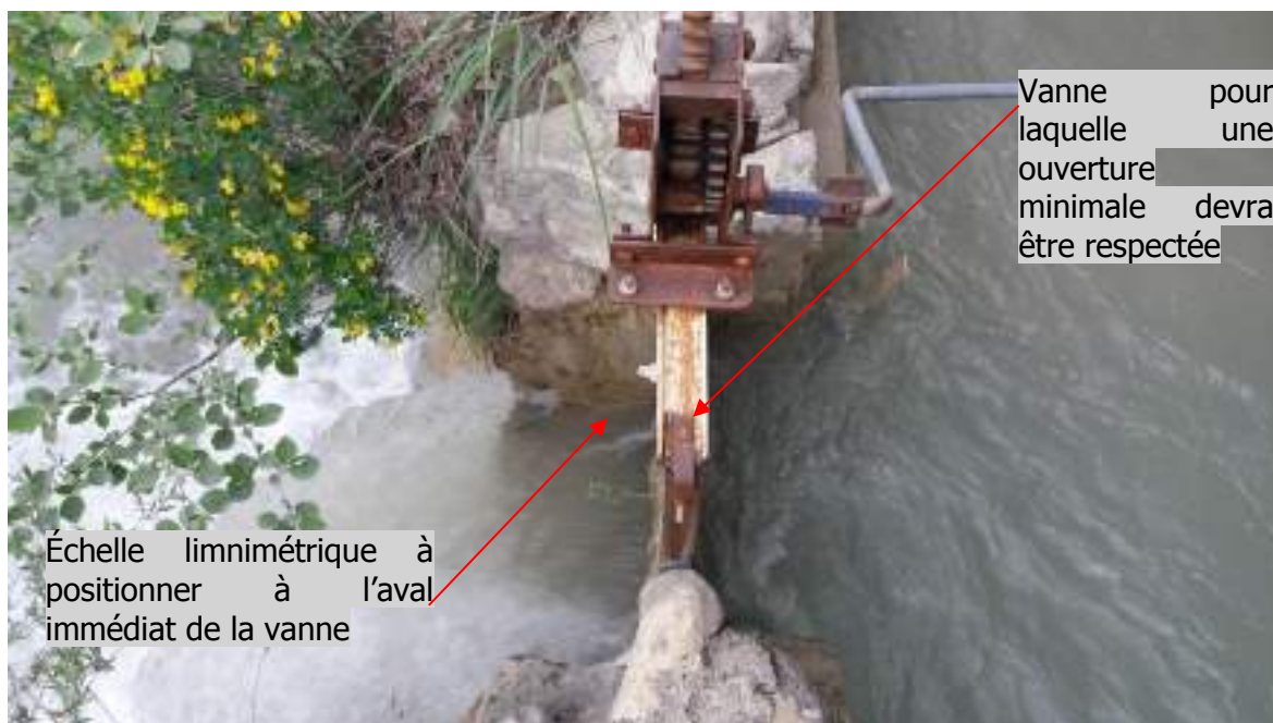
Figure 9 : Vue de la vanne de décharge et localisation de l'échelle de contrôle.
