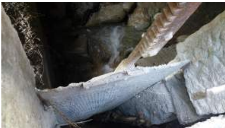
Figure 3 : Vue de la vanne de décharge en tête de la grille de prise.
