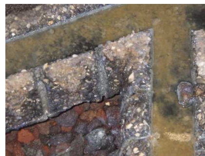
Goulottes de répartition
