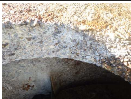
Regard du décanteur digesteur
