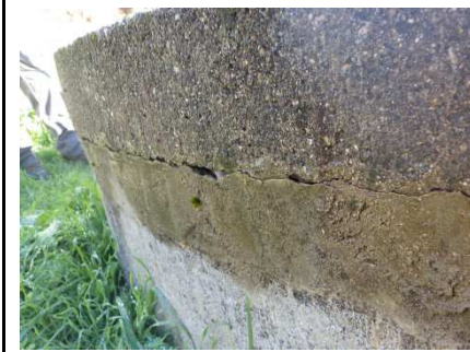
Paroies extérieures du filtre bactérien
