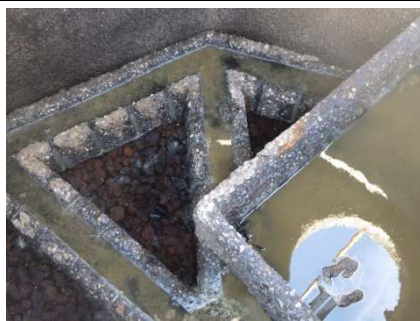
Goulottes de répartition
