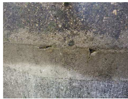
Paroies extérieures du filtre bactérien
