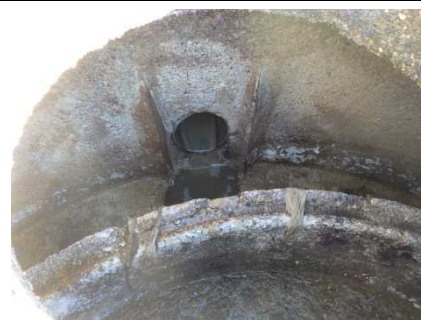
Arrivée des effluents
