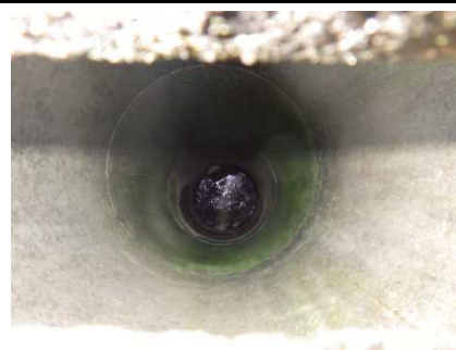
Regard de contrôle
