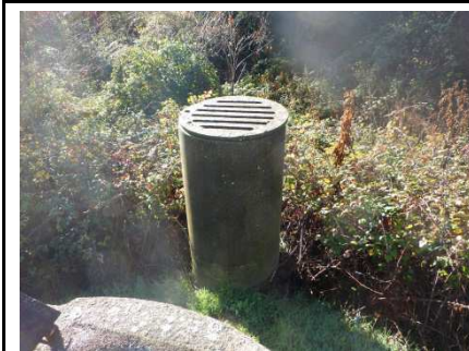
Regard de contrôle
