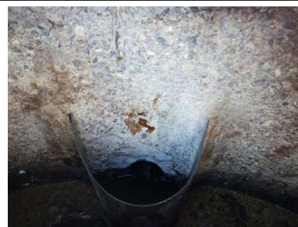
Sortie du décanteur digesteur
