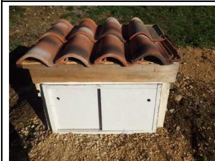
Coffret électrique et AEP
