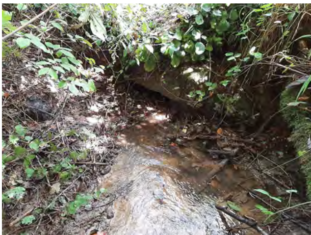
Ouvrages de la RD 921 ensablés (Commun, Neyret)
