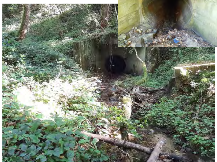
Bois flottés risquant de se bloquer à l'amont du passage sous l'autoroute (Neyret).
