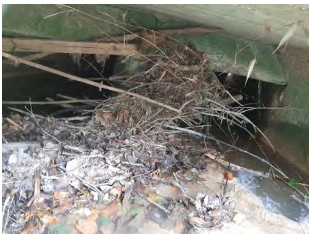
Branches coupées obstruant l'ouvrage de la RD901 (Tuilerie)
