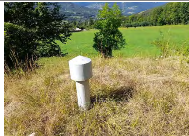
Event d'aération de la cuve
