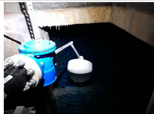
Trémie d'accès à la cuve. Cuve équipée d'un robinet flotteur
