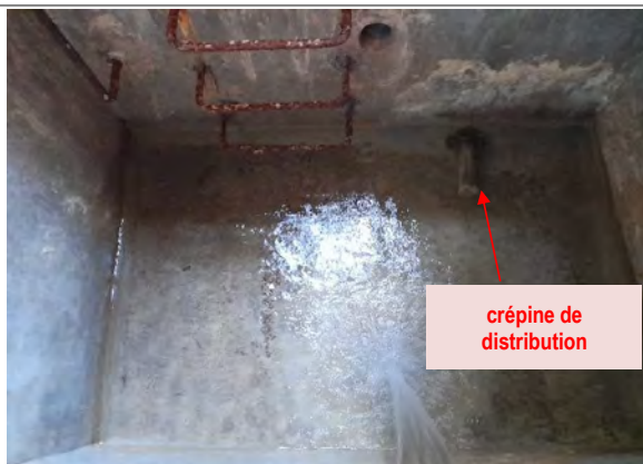
Barreaux d'accès rouillés et crépine de distribution
