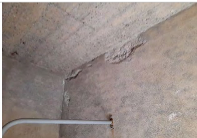
Epaufrures voile bâtiment technique
