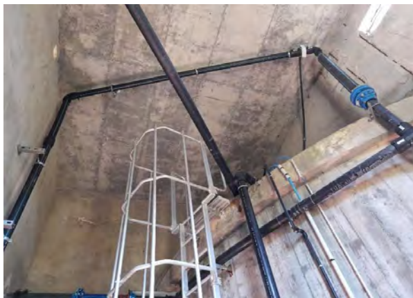
Echelle d'accès à la cuve dotée d'une crinoline
