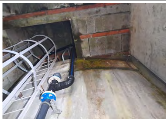
Couverture en poutrelle hourdis en parpaings, développement de mousse sur la ceinture supérieure de la cuve
