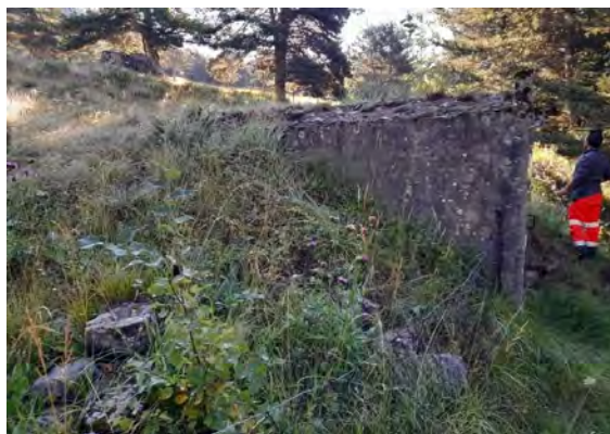
Ouvrage de captage de la source des Granges bas
