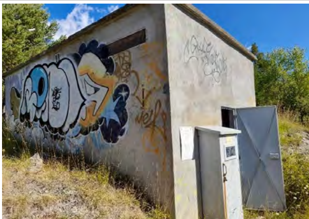
Bâtiment technique avec loquette à chlore et présence de tags
