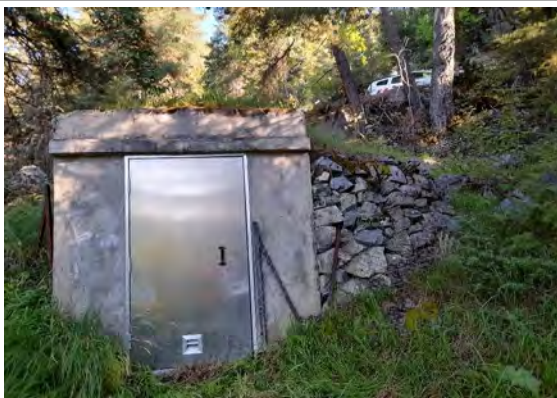
Ouvrage de captage les Granges haut
