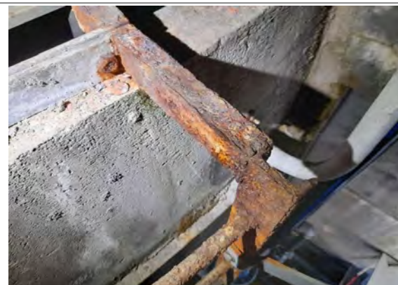
Corrosion de l'échelle d'accès à la cuve (depuis le bâtiment technique)
