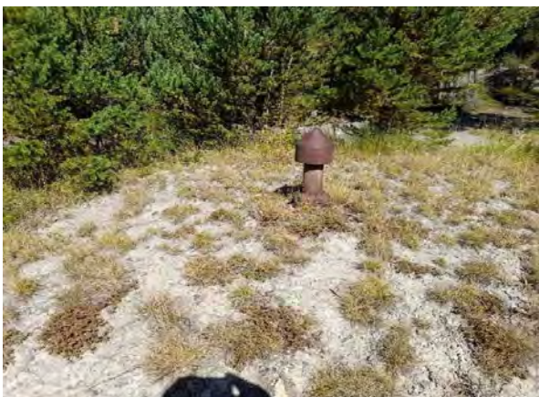
Event métallique d'aération
