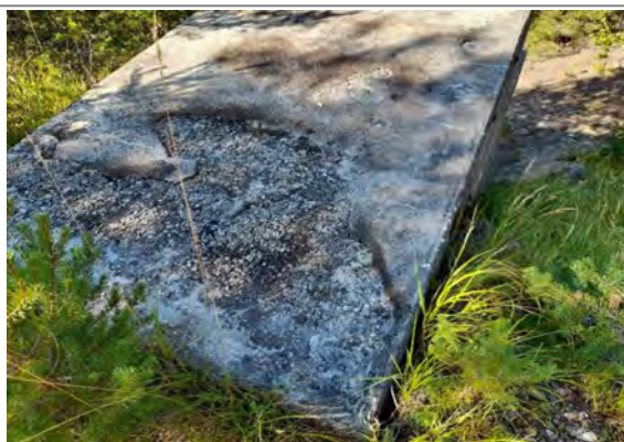
Vue de la couverture du bâtiment technique depuis la couverture remblayée de la cuve. Epaufrures du béton de couverture
