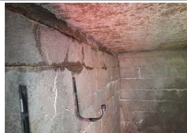
Fissuration des voiles en maçonnerie
