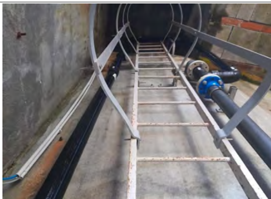
Echelle d'accès à la cuve dotée d'une crinoline
