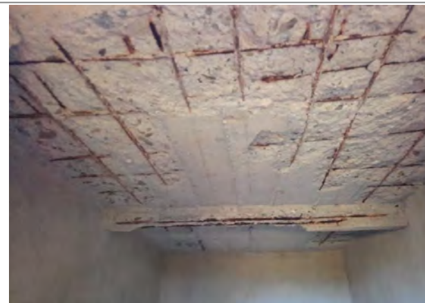
Couverture de l'ouvrage du captage, armatures apparentes corrodées
