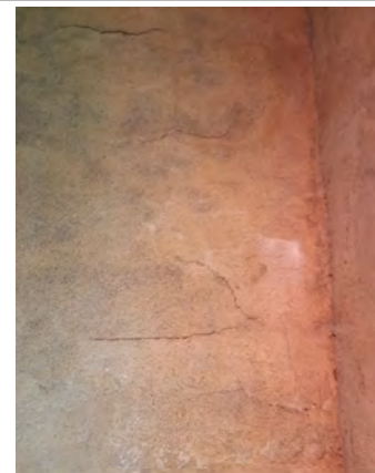
Fissuration et épaufrures du béton du voile bâtiment technique
