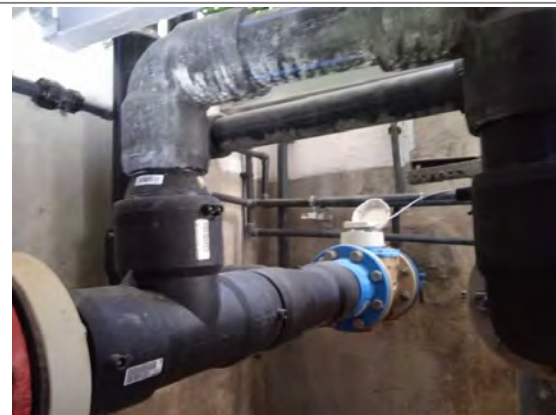
Canalisation de distribution et compteur de distribution
