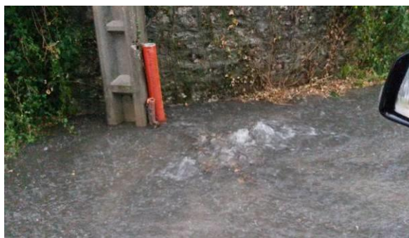
Photo 7 : Grille qui déborde
