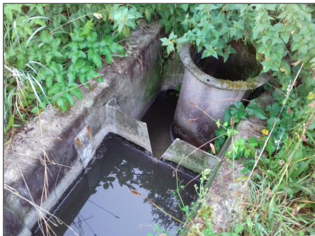
Photographies de la station d'épuration (poste de relevage, bassin d'aération, clarificateur et canal de sortie)
