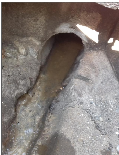
Photographie du déversoir d'orage avec surverse hors service
