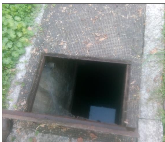
Photographie du dessableur avant rejet dans le canal
