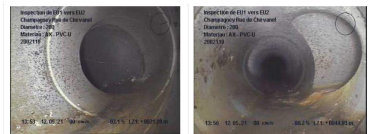
Concernant la présence d'ECP en provenance des branchements, nous préconisons dans le cadre du schéma directeur, des contrôles de branchement sur les branchements productifs identifiés ainsi que des inspections télévisuelles de ces branchements. En cas d'anomalie sur les canalisations de branchement, des travaux de réfection pourraient s'avérer nécessaires sur ceux-ci pour éradiquer les ECPP. Si des mauvais raccordements sont détectés en domaine privé, alors les particuliers devraient remettre en conformité leur branchement. Les photographies suivantes viennent illustrer les apports d'ECP détectés à la caméra.
