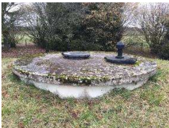
Tête de captage en béton
