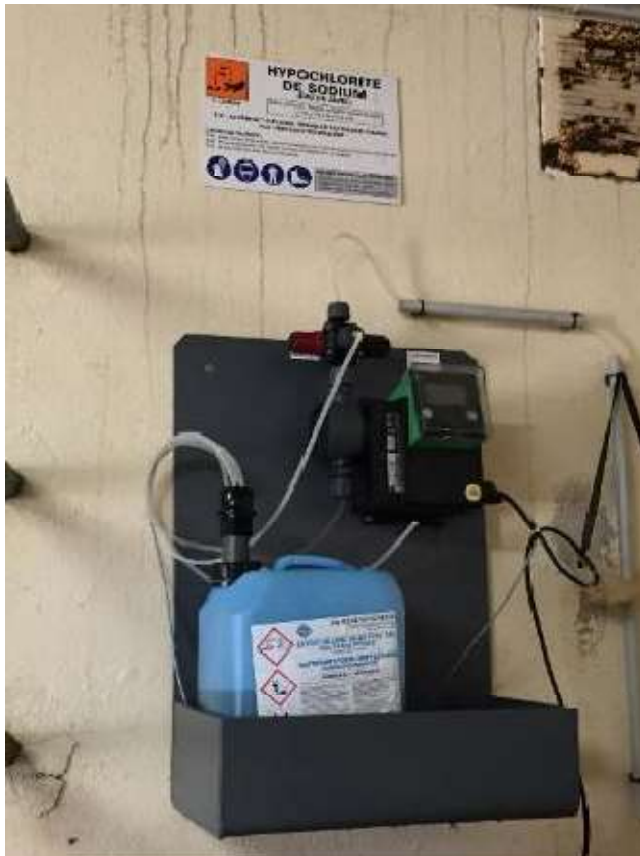
Dispositif de désinfection du réservoir
