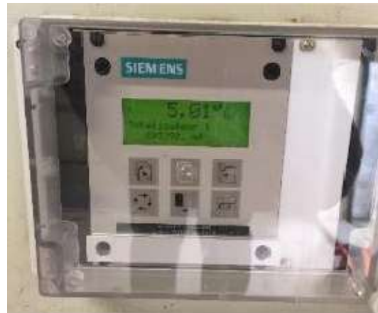
Totalisateur en entrée du réservoir
