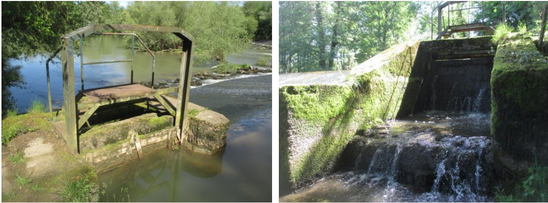
Fig. 5. Vanne de décharge du barrage
