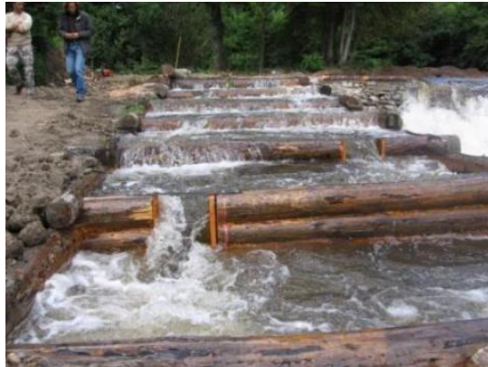
Fig. 36. Exemple de passe à bassins successifs en bois, réalisée sur le seuil de l'Argentière sur le Lignon (42)
