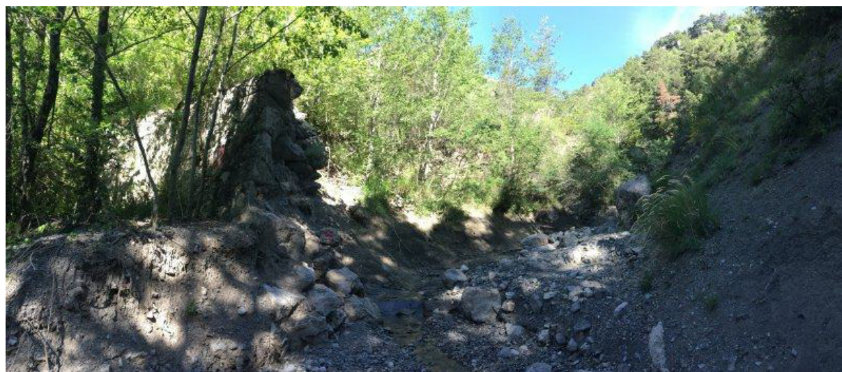
Barrage B4 détruit
