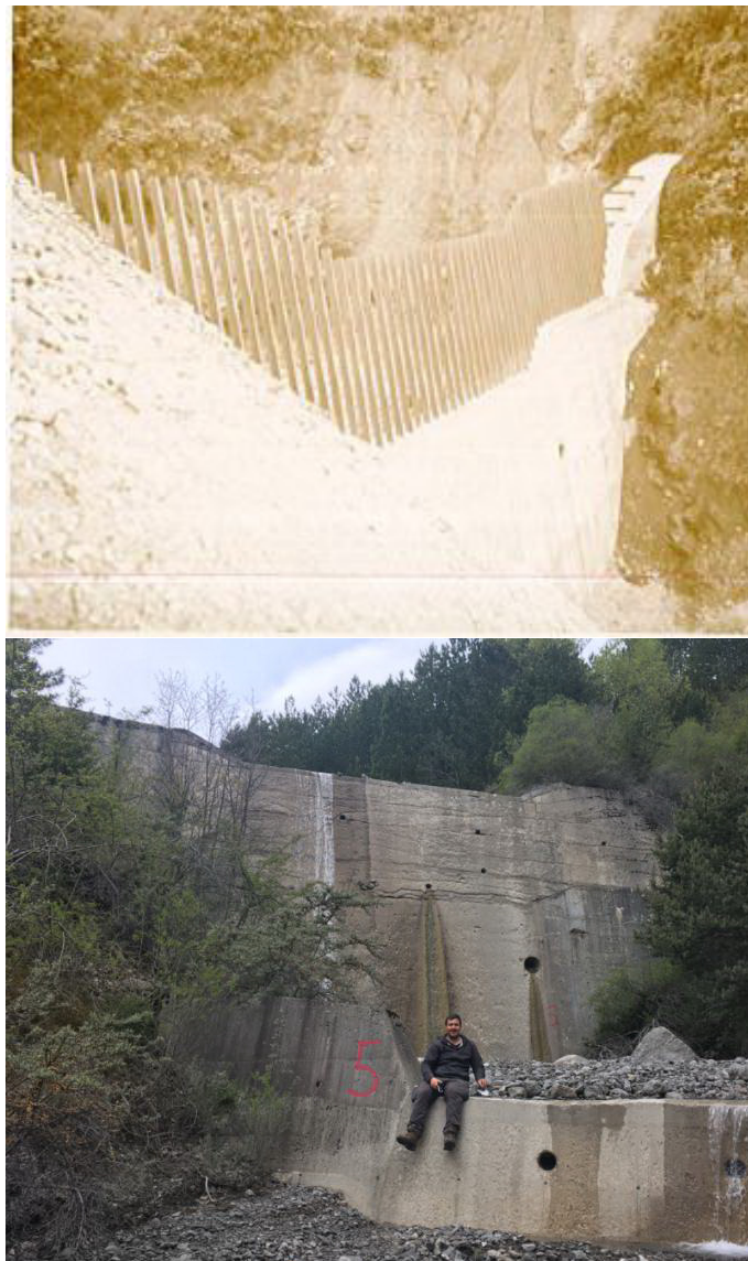
Figure 46 : Clichés du grand barrage RTM. (haut) : Avant rehausse dans les années 60 ; (bas) : 2017
