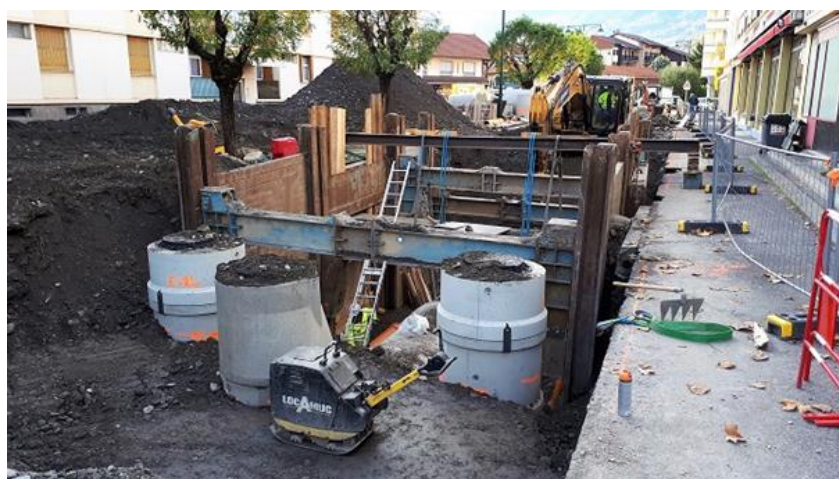
Figure 15 Mise en séparatif par destruction de la canalisation unitaire et création de la canalisation d'eaux usées
