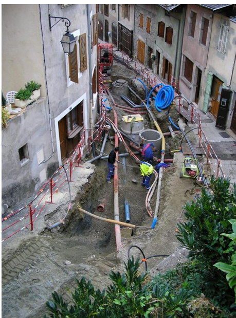
Figure 13 Mise en séparatif par création d'une canalisation à côté de la canalisation unitaire Source : Montmasson
