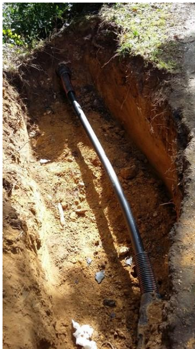
Figure 4 Canalisation de refoulement Source : Syndicat intercommunal de Marseillan 7
