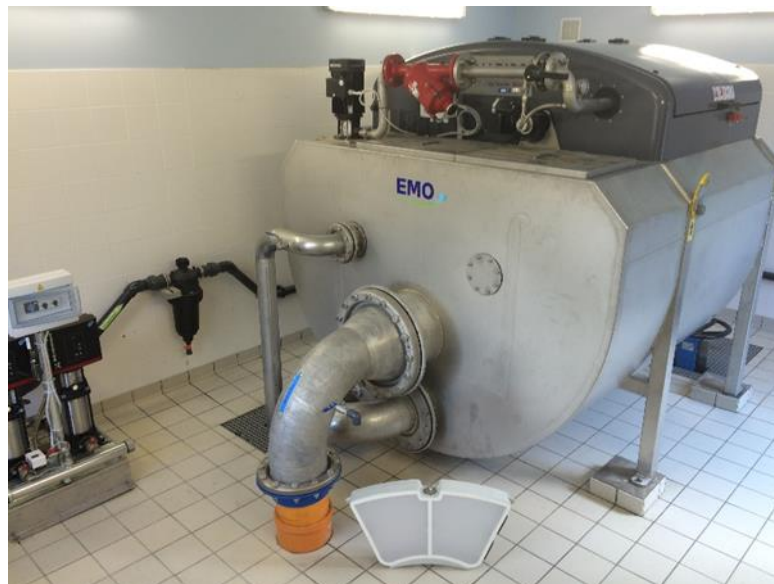
Figure 24 Traitement tertiaire par tambours filtrants Source : Montmasson
