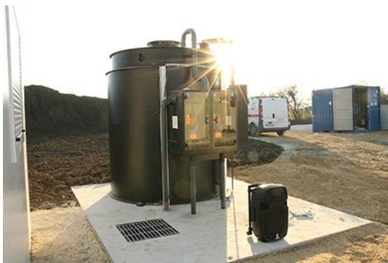
Figure 25 Réservoir de chlorure ferrique pour le traitement physico-chimique du phosphore Source : commune de Vasselay 22
