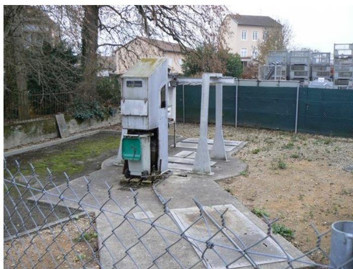
Figure 8 Poste de relèvement ou de refoulement Source : Montmasson
