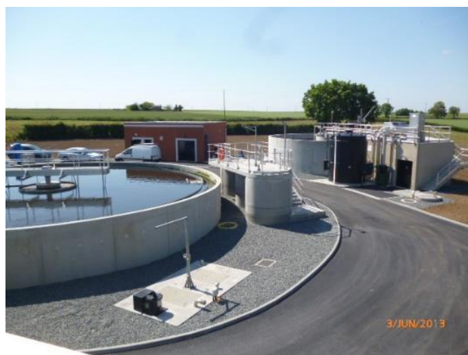
Figure 32 Station d'épuration à boues activées avec traitement biologique du phosphore Source : Hydro Europe Service 31
