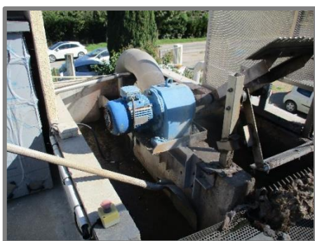
Dégrilleur et PR entrée STEP
