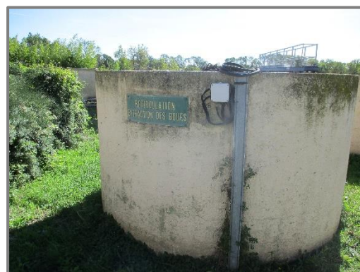
Puits de recirculation des boues
