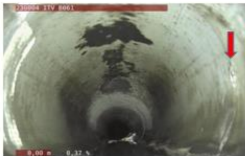
C : Infiltration sur jonction regard
