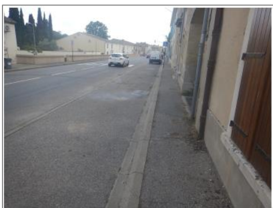
Anomalie 39 (boîte de branchement défectueuse)
