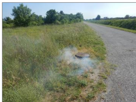
Anomalie 1 (boîte de branchement défectueuse)
