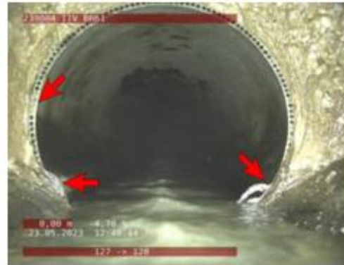
B : Infiltration sur jonction regard
