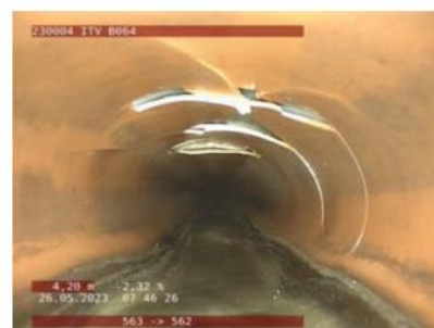
H : Fissure et réparation ponctuelle
