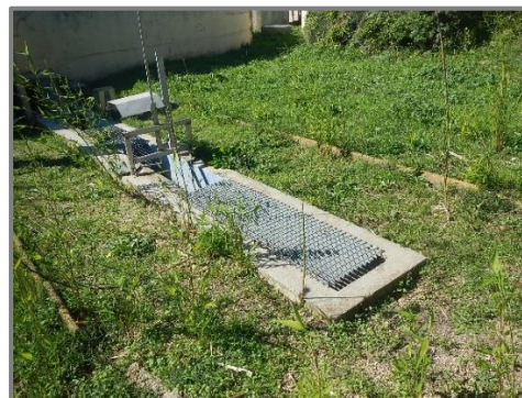
Canal de sortie
