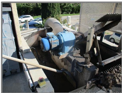
Dégrilleur et PR entrée STEP
