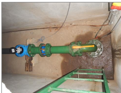
Compteur de production sur forage (f4)
