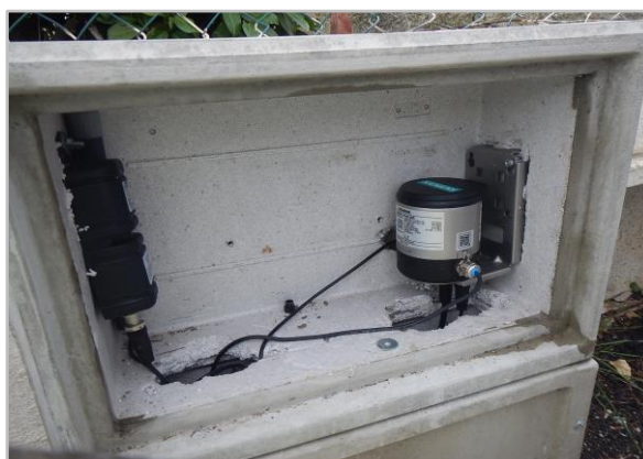
Système de communication du débitmètre Boissières
