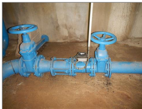
Chambre de vannes avec débitmètre
