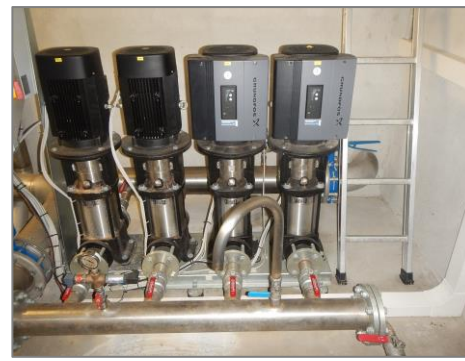
Groupe de pompage
