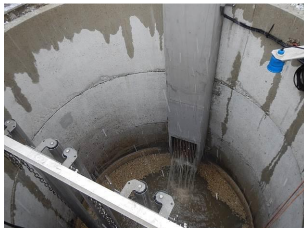
Poste de relèvement général avec dégrilleur automatique
