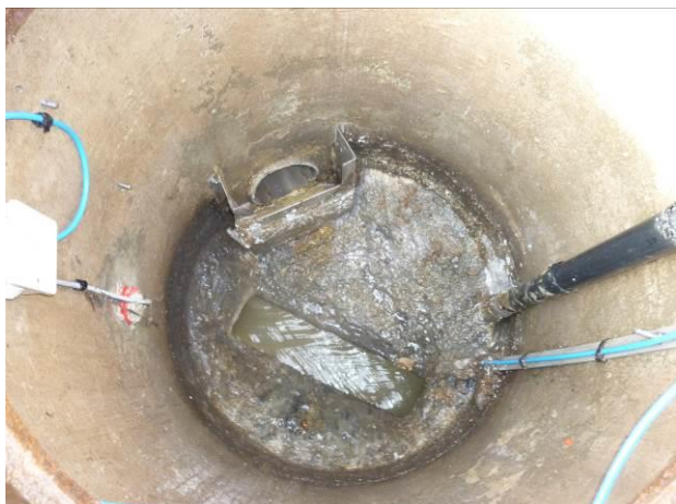
Equipement déversoir d'orage
