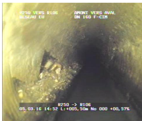
Cassure sur tronçon
