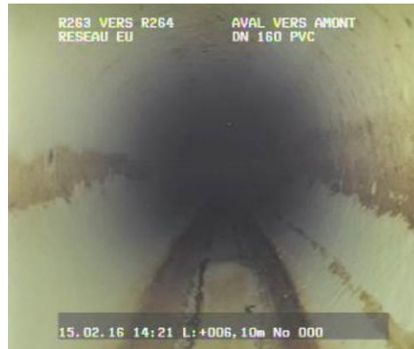
Dégradation de surface (renflement interne)
