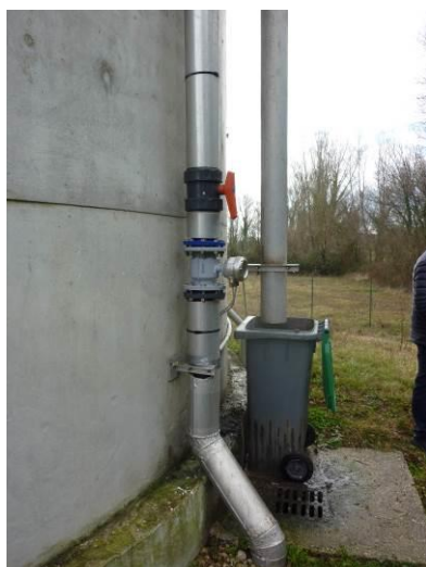
Débitmètre sur conduite de refoulement STEP
