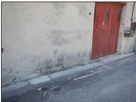
Anomalie 31 (boîte de branchement défectueuse dans caniveau)
