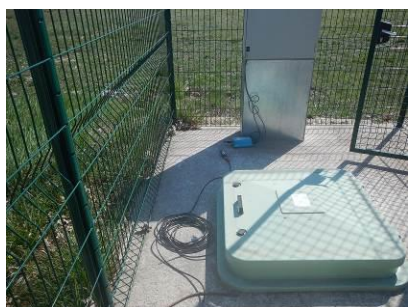
Point n°6 (pompes)
