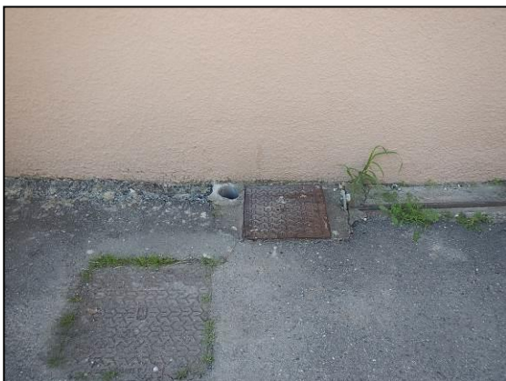
Anomalie 9 – Conduite percée à proximité boîte de branchement
