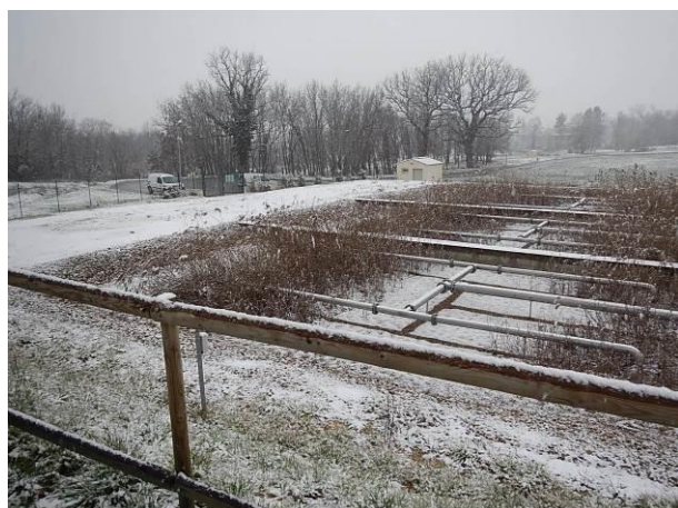
Filtres plantés de roseaux (1 er étage)
