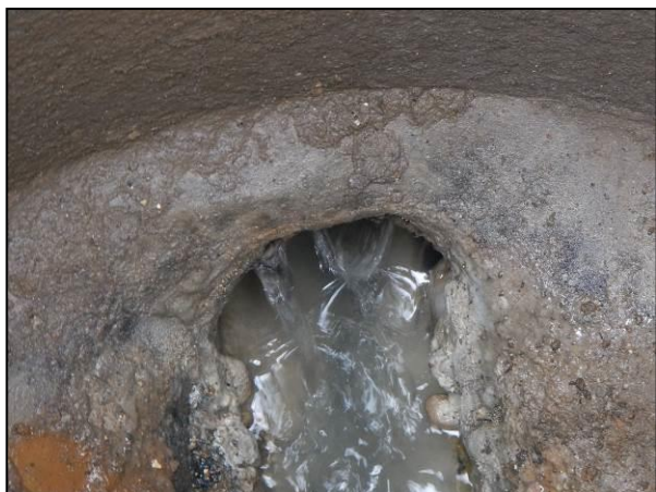
Infiltrations (Rv n°252)
