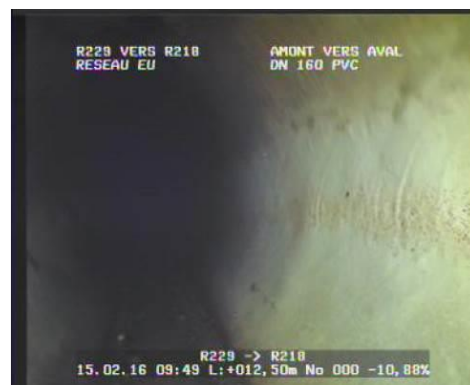
Dégradations de surface (poinçonnements)
